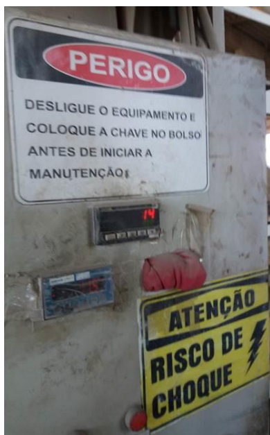
Figura 09: Painel da balança que realiza a dosagem dos agregados
