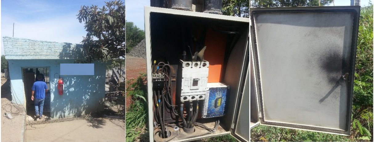
Figura 6: Sala de controle e quadro de energia
