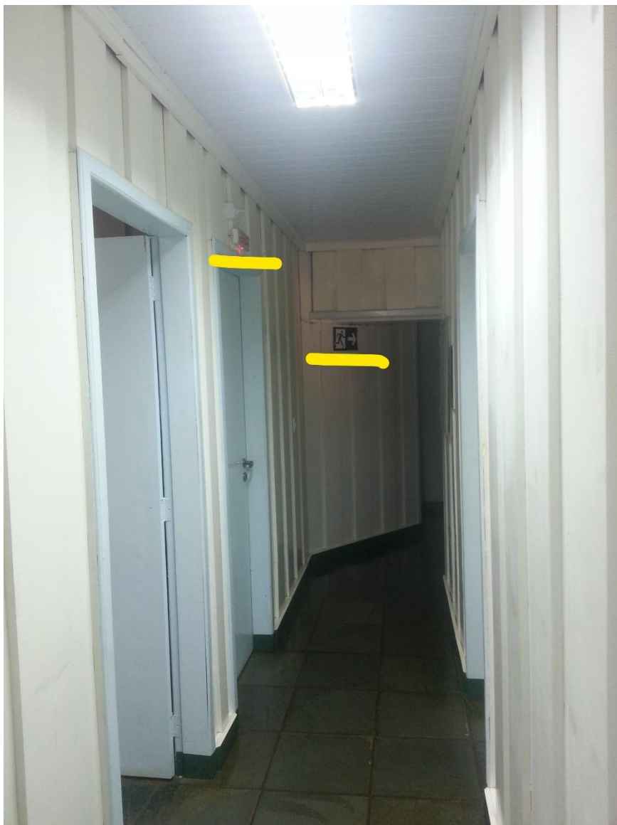
Figura 4: Sinalização e iluminação de emergência área administrativa
