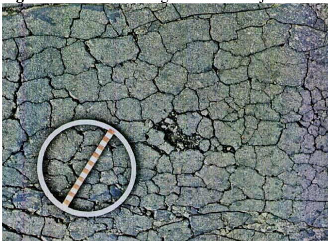
Figura 03: Trinca interligada “couro de jacaré”.
