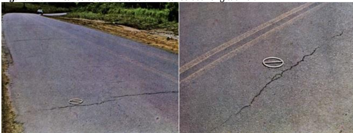
Figura 02: Trinca isolada transversal/ Trinca isolada longitudinal.
