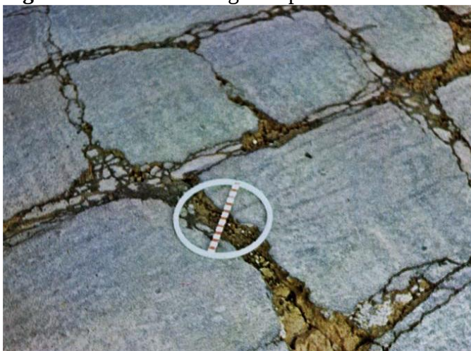
Figura 04: Trinca interligada tipo bloco.
