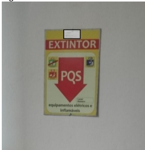
Figura 7: Placa em desconformidade
