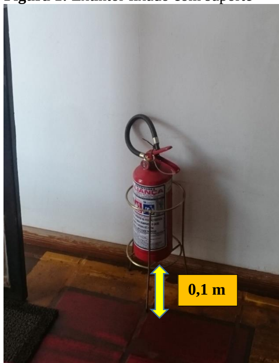
Figura 1: Extintor fixado com suporte
