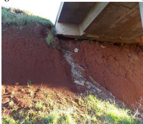
(a) Erosão do talude de apoio.
