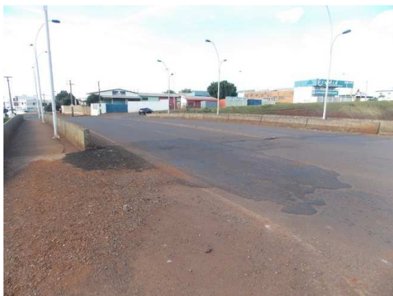
(c) Patologia encontrada Av. Rocha Pombo.
