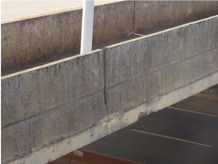
Figura 18: Desagregação do concreto na laje em balanço
