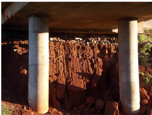
(a) Pilares e aparelhos de apoio com poucas fissuras.
