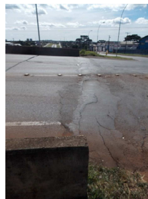
(d) Patologia encontrada Av. Rocha Pombo
