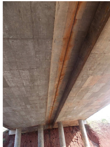
(b) Manchas encontradas na união das lajes centrais
