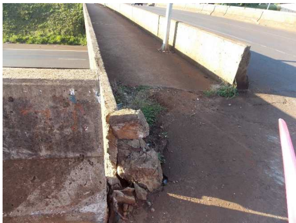
(a) Guarda-corpo com desagregação de concreto devido à um provável acidente.
