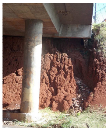
(b) Erosão do talude de apoio.
