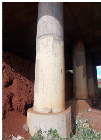
(b) Pilares com nichos de concretagem.
