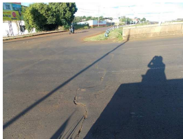
(b) Patologia encontrada Viaduto Rua Jacarezinho
