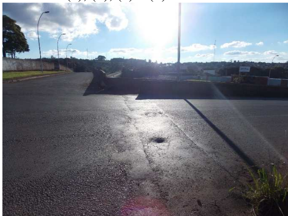
(a) Patologia encontrada Viaduto Rua Jacarezinho.
