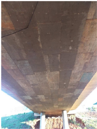
(a) Manchas encontradas em toda a extensão da laje central
