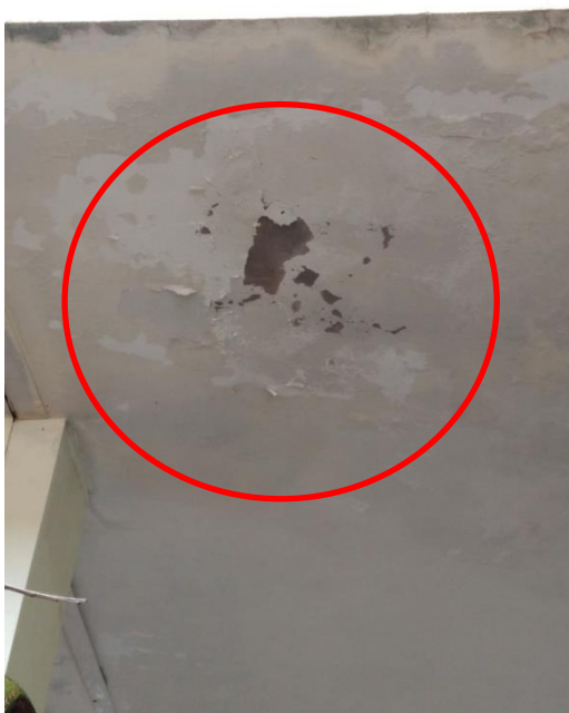
Figura 24: Descolamento da pintura
