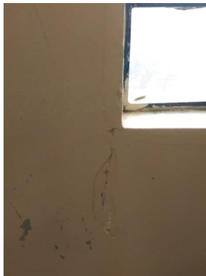
Fissura por sobrecarga em abertura
