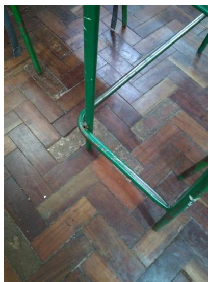
Descolamento do piso
