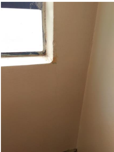
Fissura por sobrecarga em abertura
