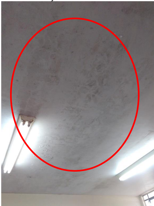
Figura 23: Presença de mofo
