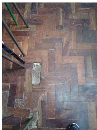
Descolamento do piso
