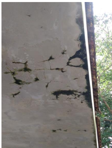
Fissura por retração da argamassa/Bolor
