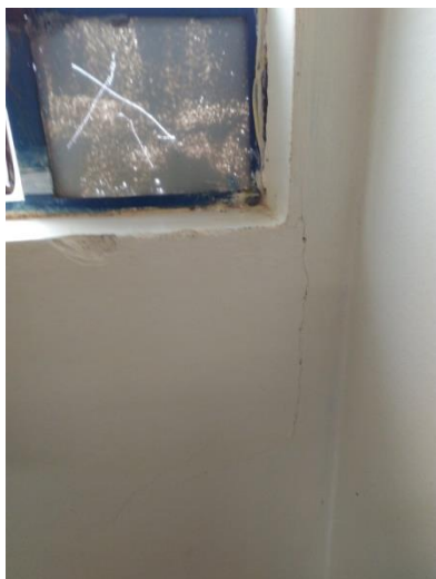
Fissura por sobrecarga em abertura
