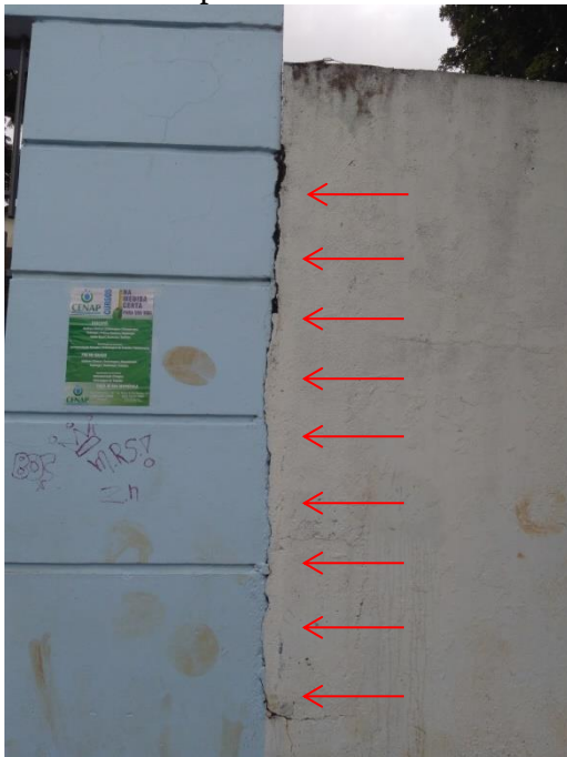
Figura 21: Fissura por deficiência/falta de amarração
