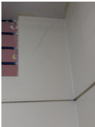
Fissura por sobrecarga
