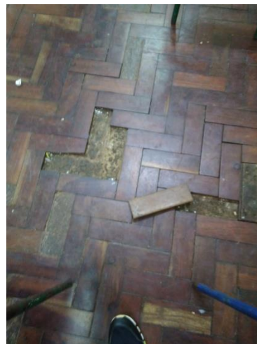
Descolamento do piso
