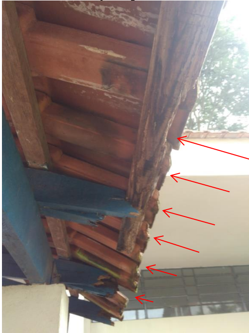
Figura 26: Deterioração/apodrecimento da madeira
