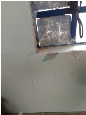
Fissura por sobrecarga em abertura
