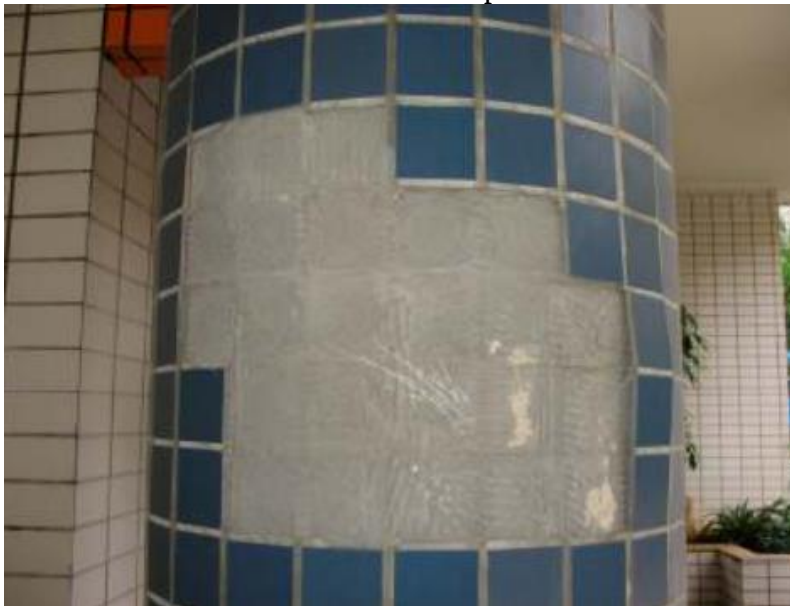
Figura 06: Descolamento do revestimento por falta de aderência
