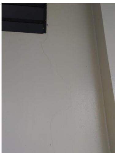
Fissura por sobre carga em abertura
