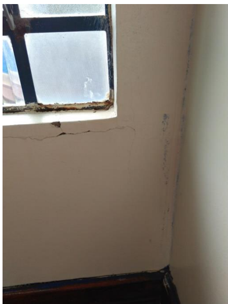
Fissura por sobrecarga em abertura
