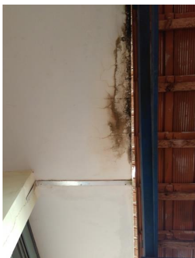
Fissura por retração da argamassa/Bolor
