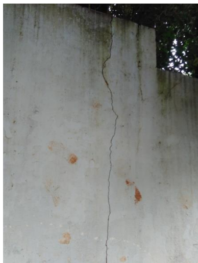
Fissura por falta de amarração entre alvenaria e pilar/Bolor
