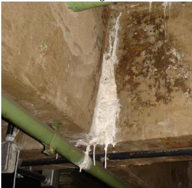
Figura 03: Eflorescência na viga
