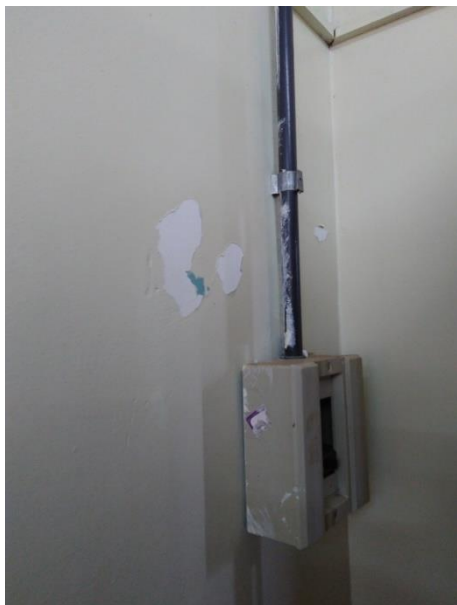
Descolamento da pintura
