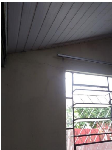
Bolor / Fissura por sobrecarga em abertura
