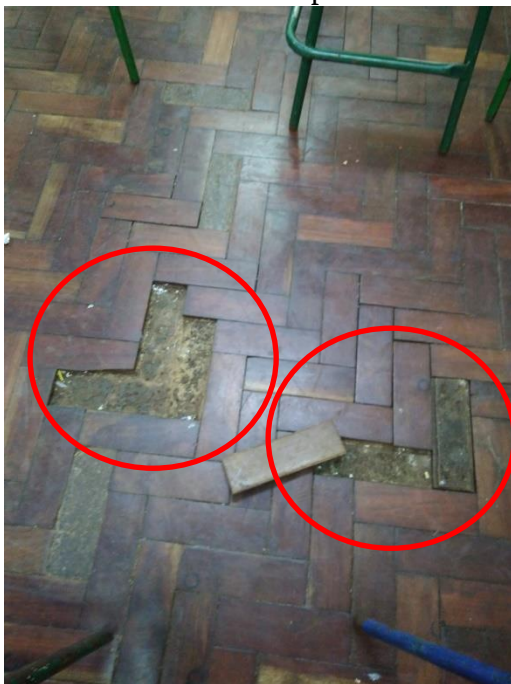
Figura 25: Descolamento do piso
