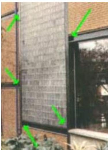
Figura 01: Locais suscetíveis à infiltração
