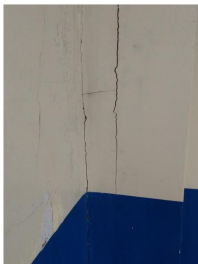
Fissura por falta de amarração entre alvenaria e pilar
