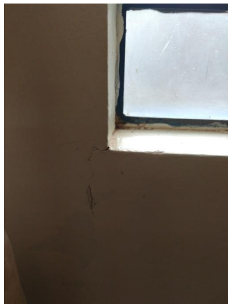
Fissura por sobrecarga em abertura
