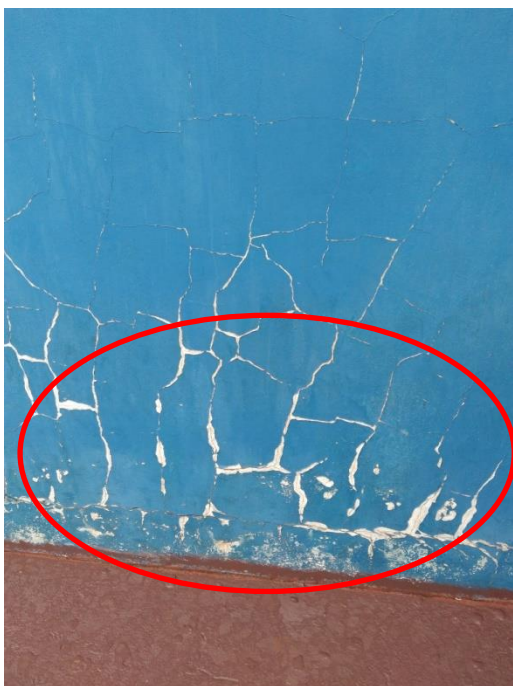
Figura 19: Fissura por movimentação higroscópica
