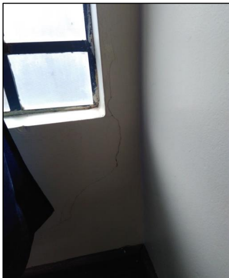
Fissura por sobrecarga em abertura
