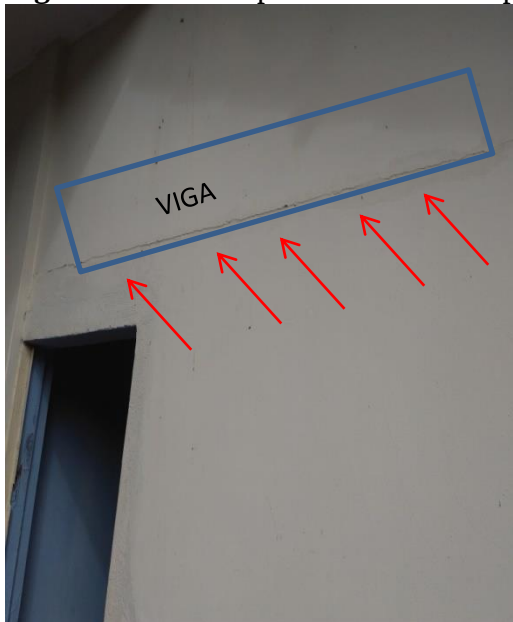
Figura 16: Fissura por encunhamento precoce ou ausência do mesmo
