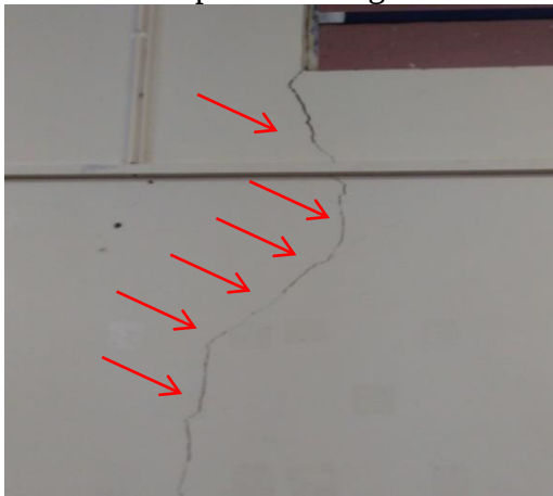
Figura 13: Fissura por sobrecarga em abertura
