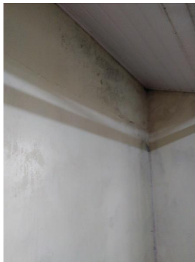
Bolor/Fissura por retração da argamassa
