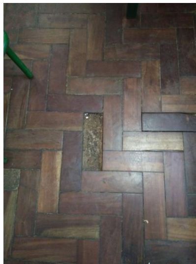
Descolamento do piso
