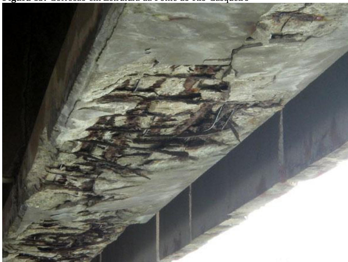
Figura 15: Corrosão em Estrutura da Ponte do Rio Casqueiro
