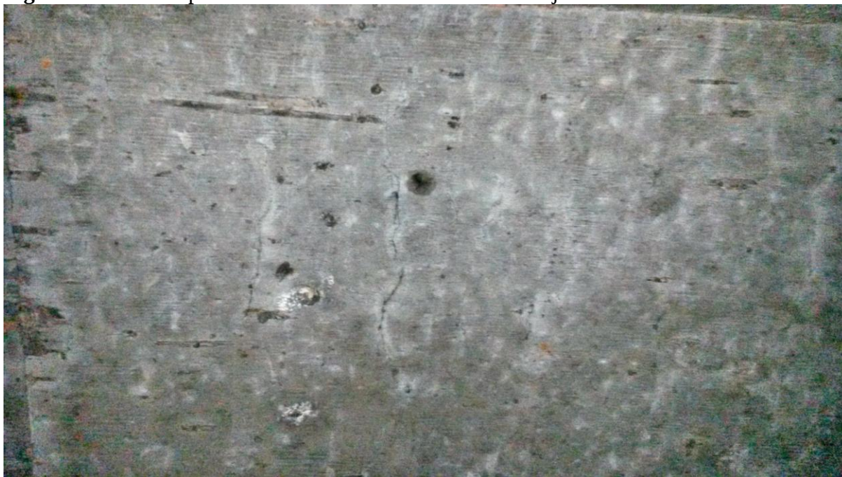
Figura 34: Fissuras primárias de flexão na face inferior da laje
