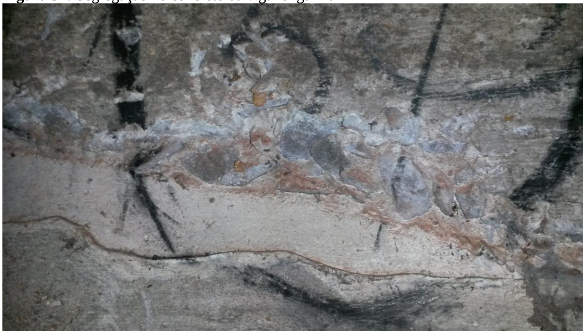
Figura 37: Segregação no concreto da viga longarina
