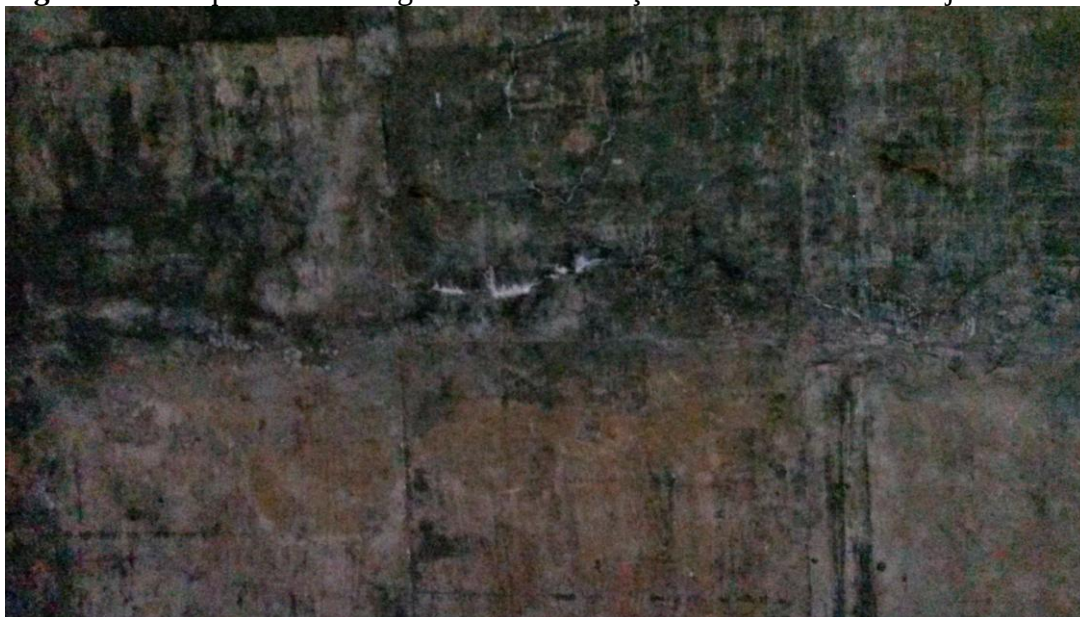
Figura 35: Ataque de microorganismos e lixiviação na face inferior da laje
