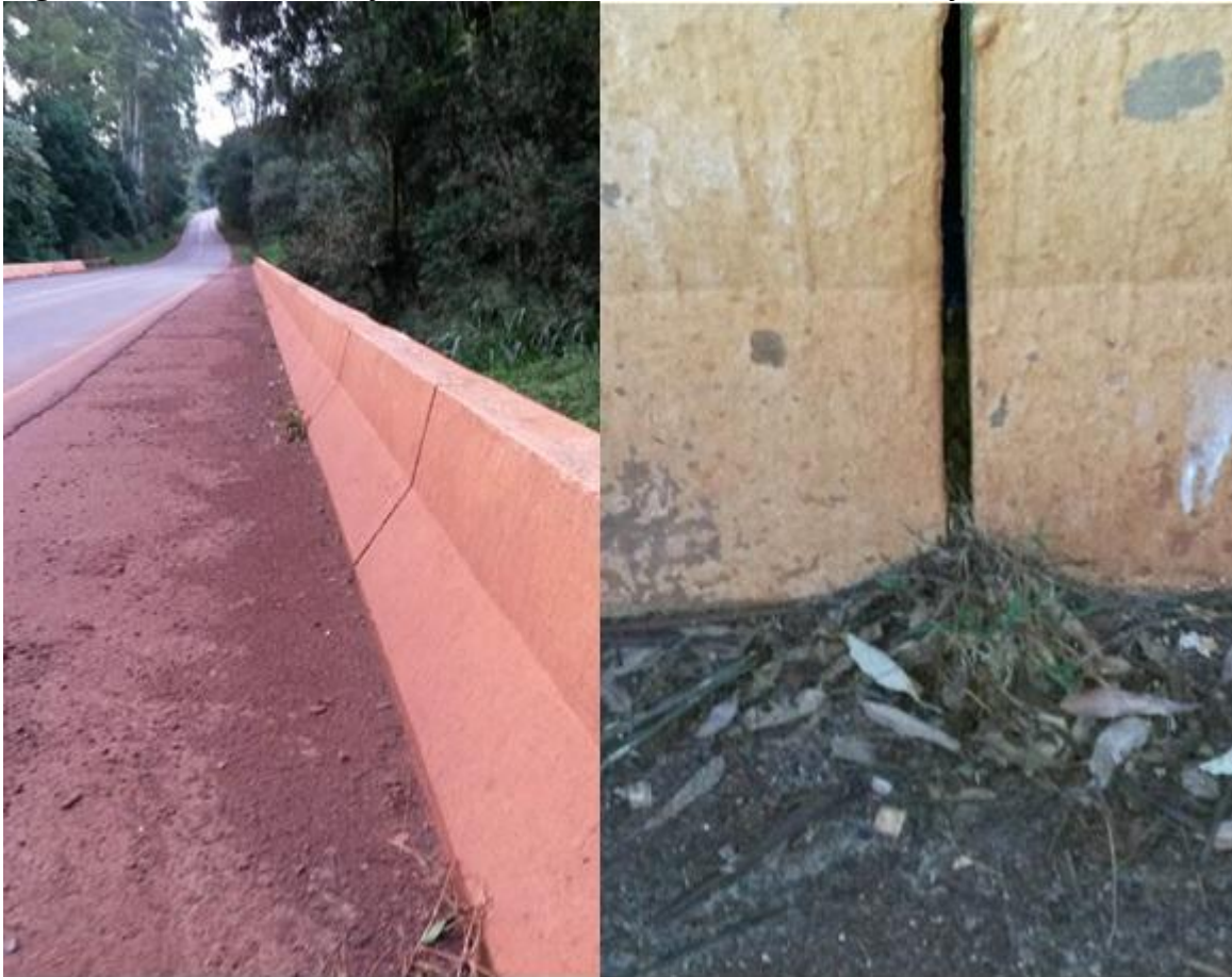
Figura 38: Acúmulo de sujeira nos acostamentos e a eventual obstrução dos drenos
