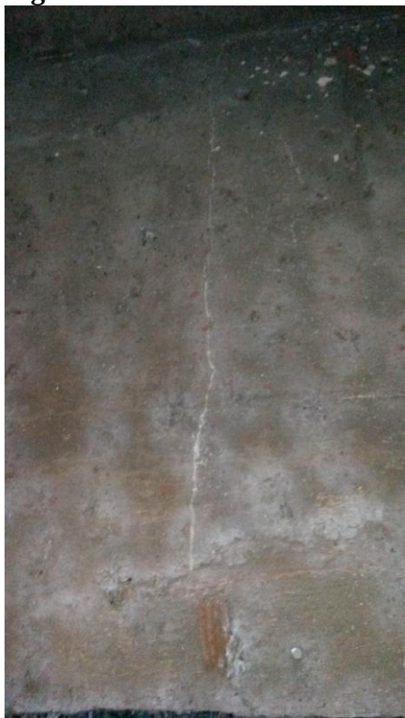
Figura 36: Fissura com eflorescência em viga longarina
