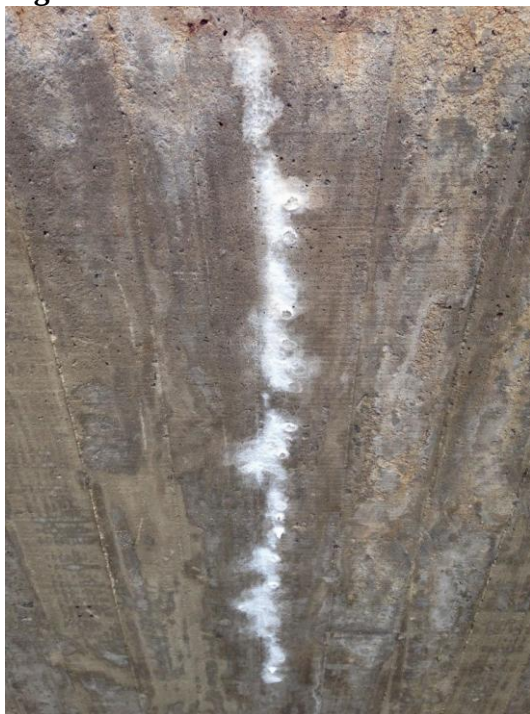
Figura 30: Eflorescência em fissura no concreto aparente
