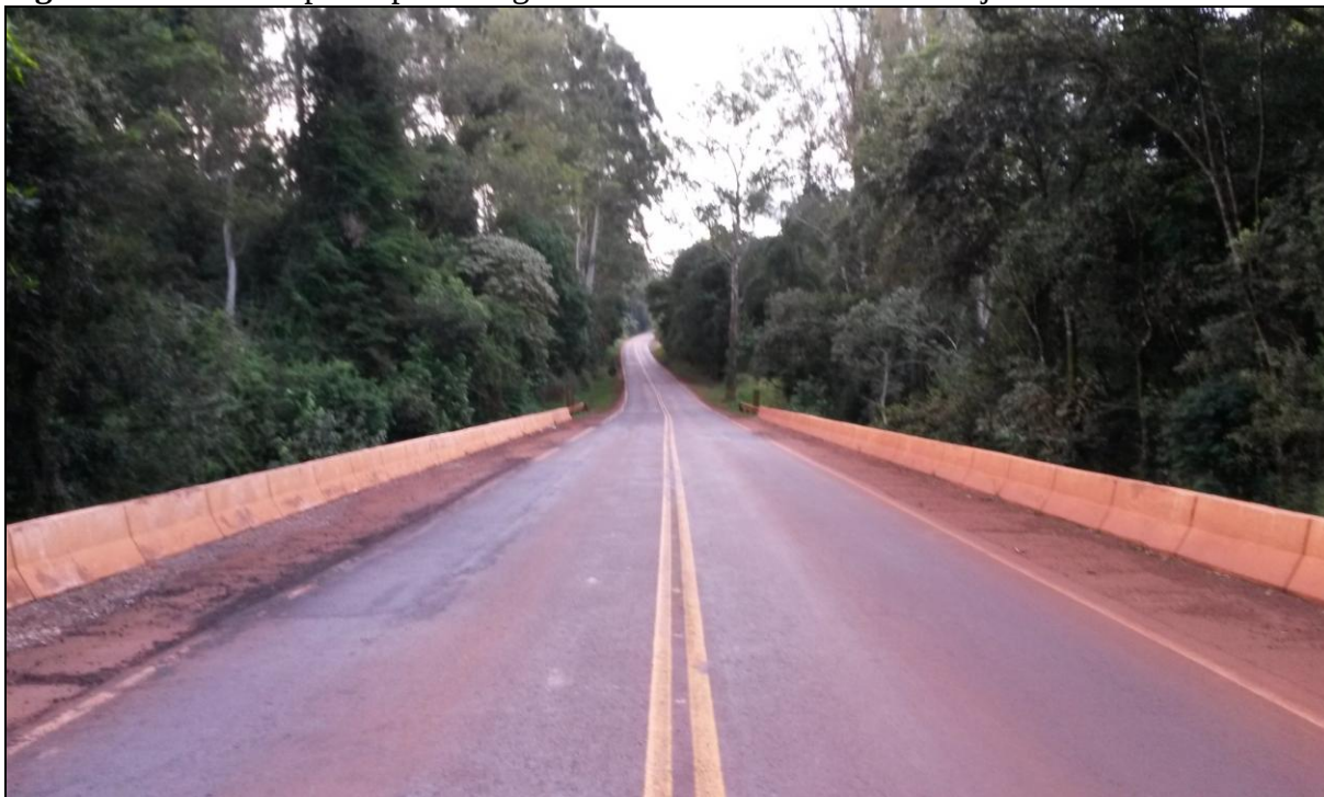
Figura 33: Acesso à ponte pela margem de Corbélia e acúmulo de sujeira nos acostamentos
