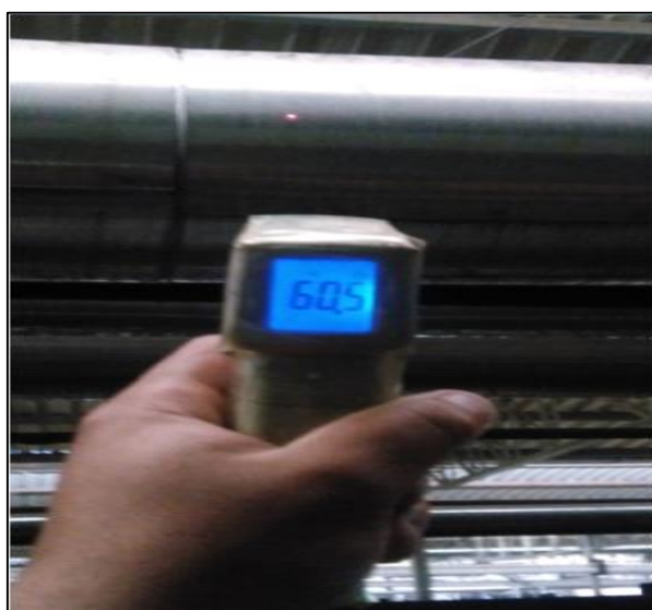
Figura 18: Temperatura do Isolamento Medido
