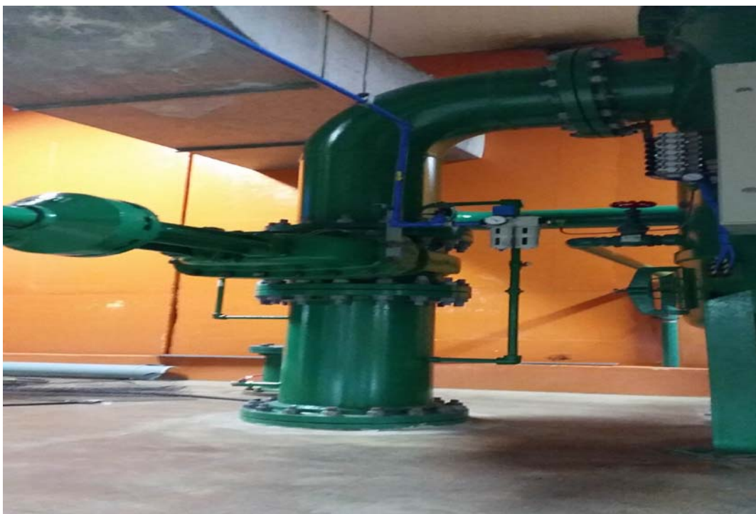
Figura 36: Tubulação para captação de água do conduto (Fonte: O AUTOR, 2016).
