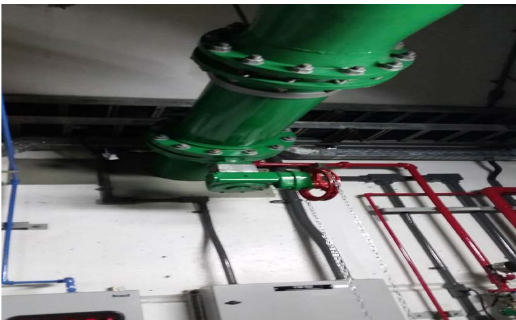
Figura 41: Tubulação de água entrada dos trocadores de calor (Fonte: O AUTOR, 2016).
