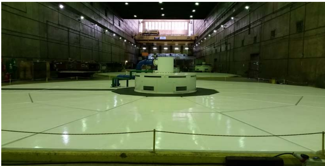
Figura 43: Gerador parte superior, tampas e cubículo anéis coletores (Fonte: O AUTOR, 2016).
