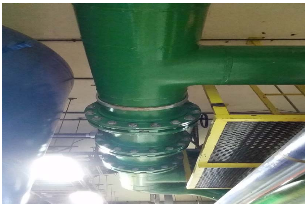
Figura 39: Válvula de isolamento do coletor geral (Fonte: O AUTOR, 2016).
