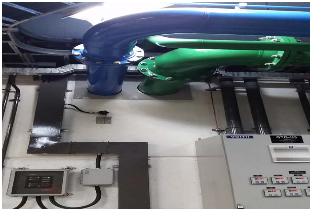
Figura 42: Tubulação de água saída dos trocadores de calor (Fonte: O AUTOR, 2016).
