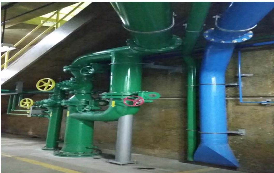
Figura 40: Tubulações de saída de água para o canal de fuga (Fonte: O AUTOR, 2016).
