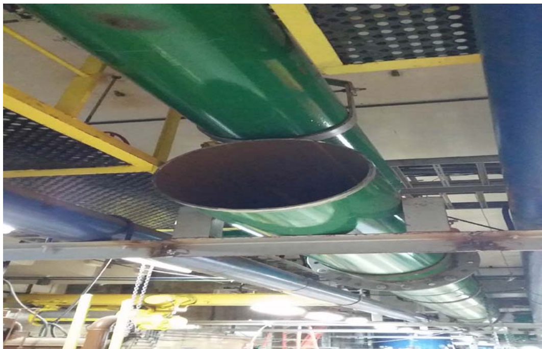
Figura 38: Tubulação de água do coletor geral (Fonte: O AUTOR, 2016).
