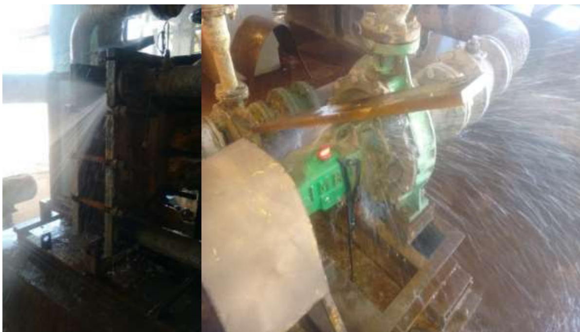
Imagem 1: Trocador de calor e bomba apresentando vazamentos de vapor e água
