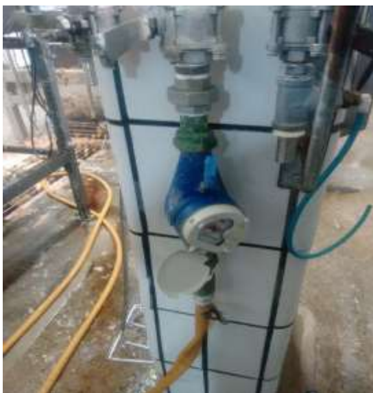
Imagem 6: Hidrômetro instalado na mangueira para medição da vazão unitária
