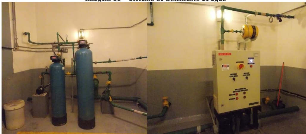
Sistema de tratamento de água
