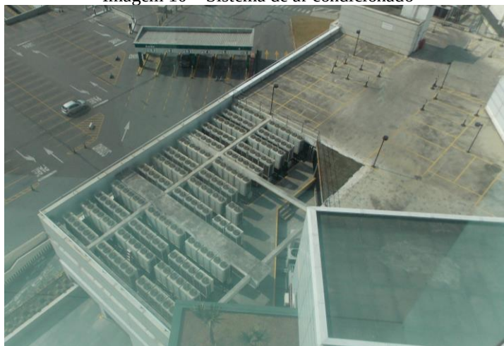
Imagem 10 – Sistema de ar condicionado
