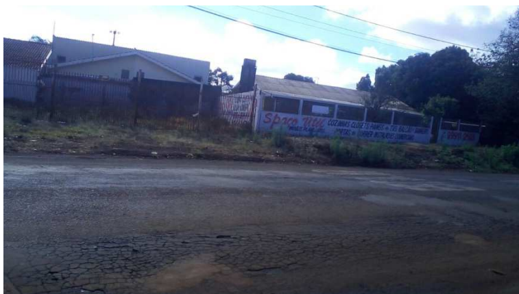
Figura 11: Deterioramento da via de rolamento e ausência de passeio público
