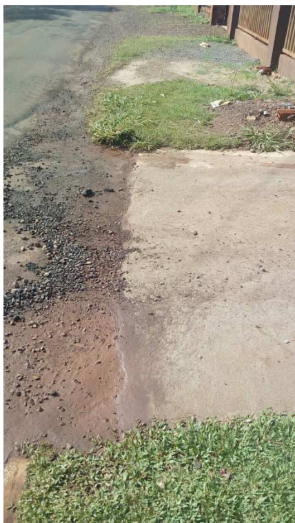
Figura 07: Deterioramento de calçada e vegetação na via de passeio público
