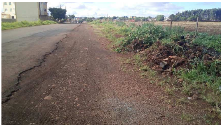
Figura 03: Ausência de calçada
