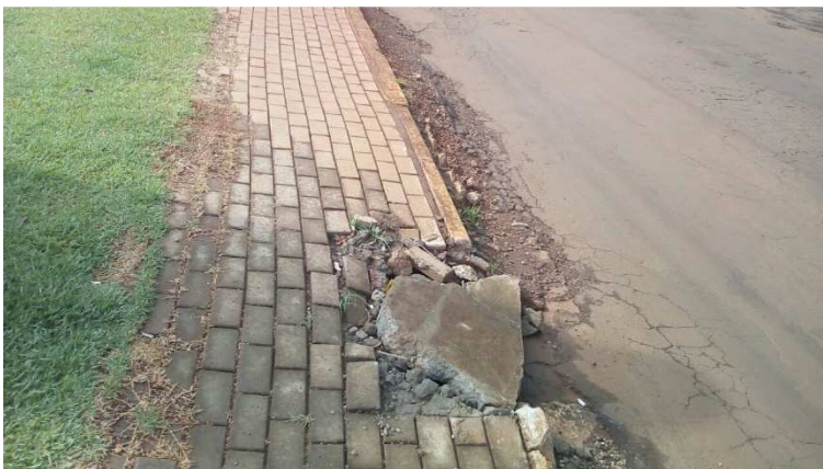
Figura 06: Deterioramento da calçada
