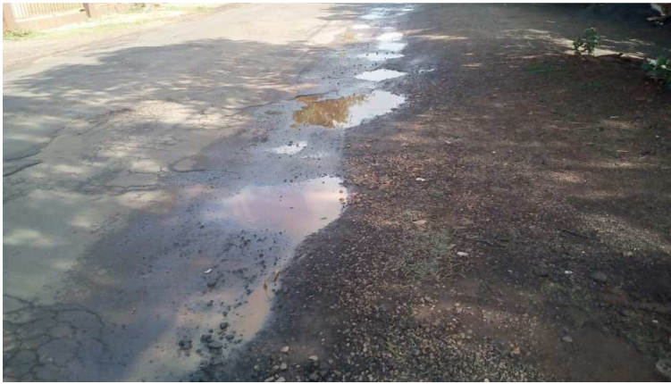
Figura 05: Ausência de calçada
