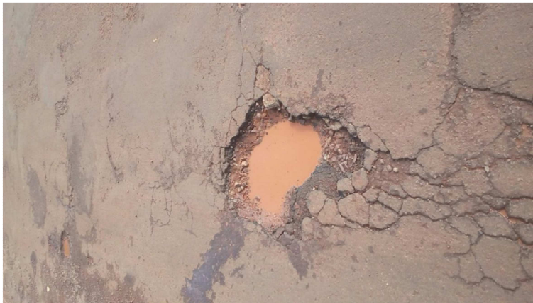
Figura 10: Buraco na via de rolamento
