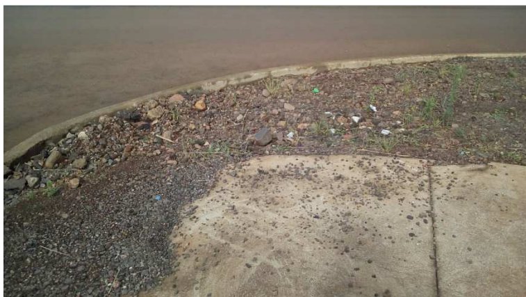
Figura 04: Deterioramento da calçada
