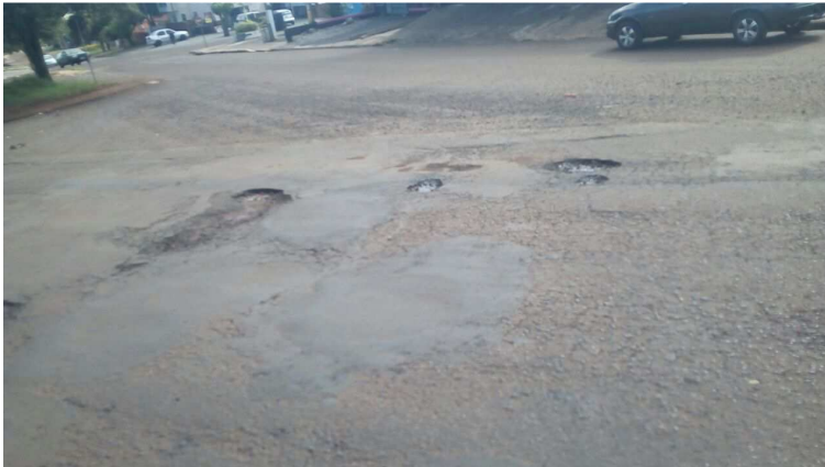
Figura 09: Deterioramento da via de rolamento
