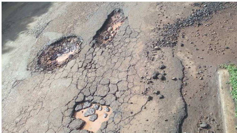
Figura 12: Indicando buracos na via de rolamento
