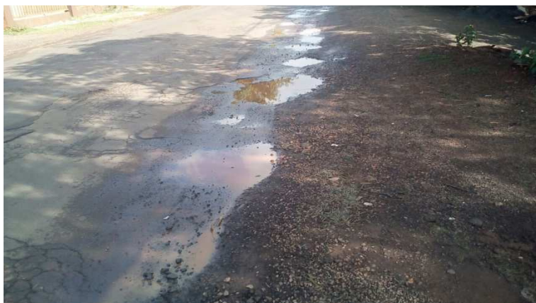
Figura 13: Deterioramento da via de rolamento e ausência do passeio público
