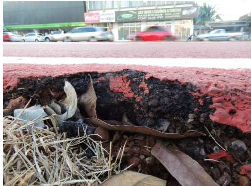
Figura 2 - Deterioração da Pavimentação da Ciclovia
