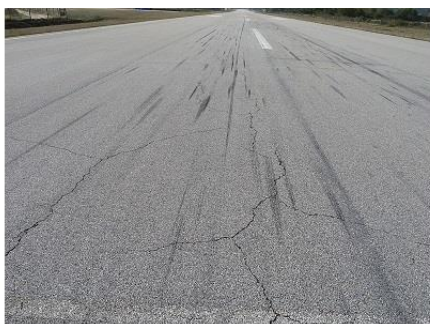
Figura 4: Trinca em pavimento
