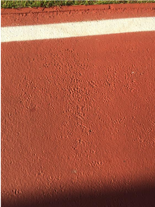
Figura 13: Desgaste no Pavimento
