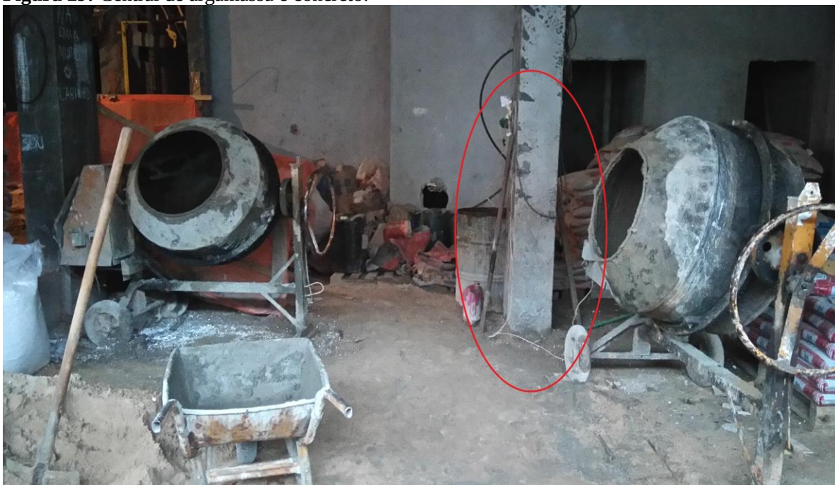
Figura 29: Central de argamassa e concreto.
