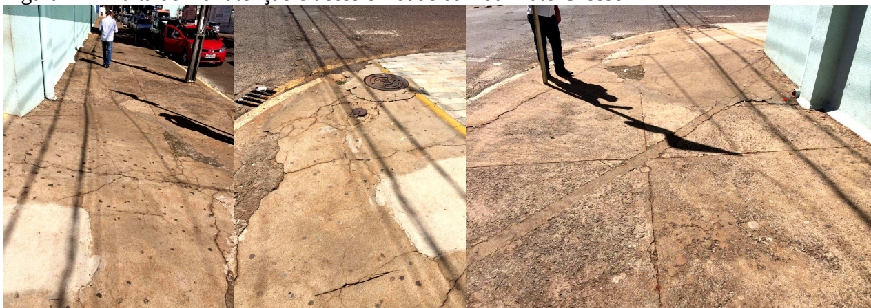
Figura 17 – Falta de manutenção e acessibilidade da Rua Mato Grosso
