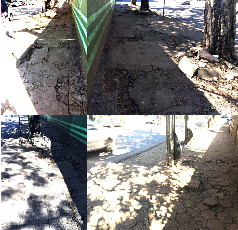
Figura 11 – Obstrução do passeio pela vegetação da Rua Paraná
