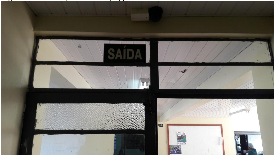
Figura 49: Sinalização de orientação, porta
