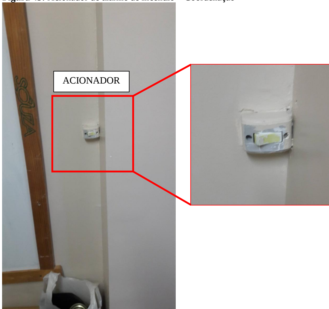
Figura 43: Acionador de alarme de incêndio – Coordenação
