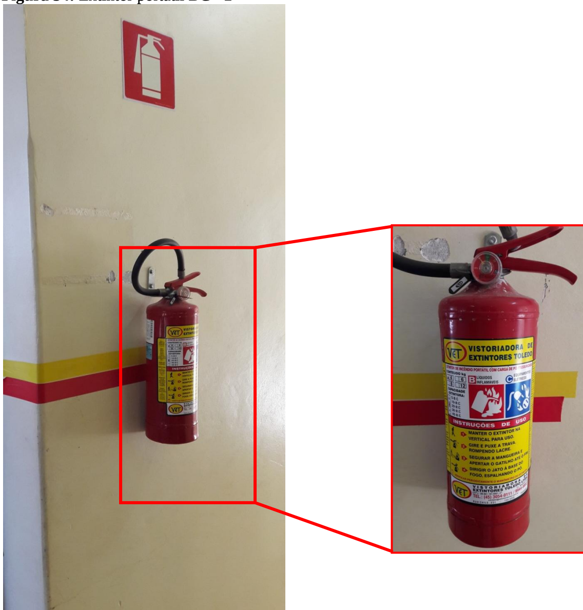
Figura 54: Extintor portátil BC - 2
