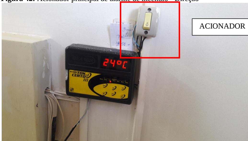
Figura 42: Acionador principal de alarme de incêndio - Direção
