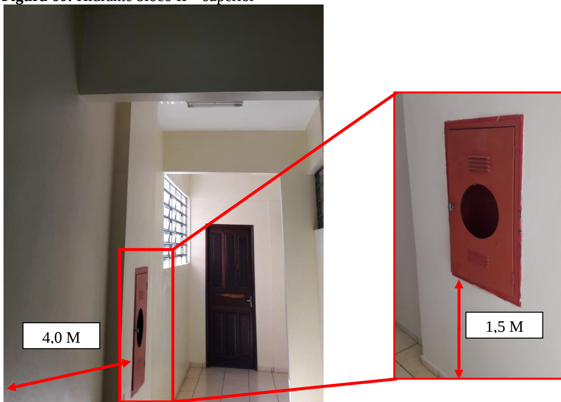
Figura 60: Hidrante bloco II – superior
