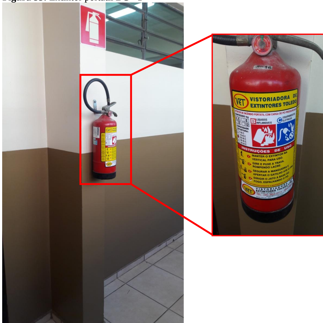
Figura 53: Extintor portátil BC - 1
