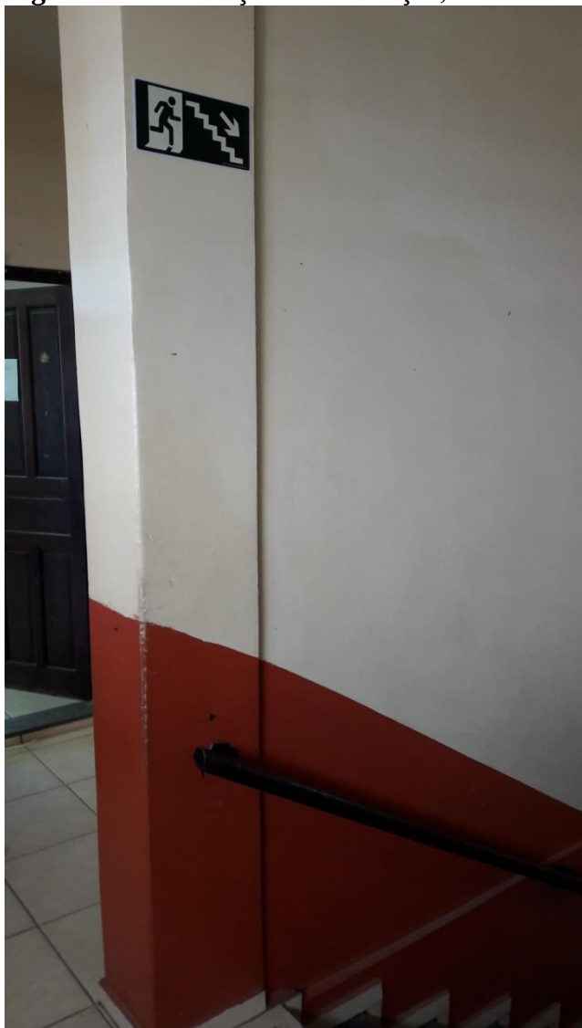
Figura 47: Sinalização de orientação, escada
