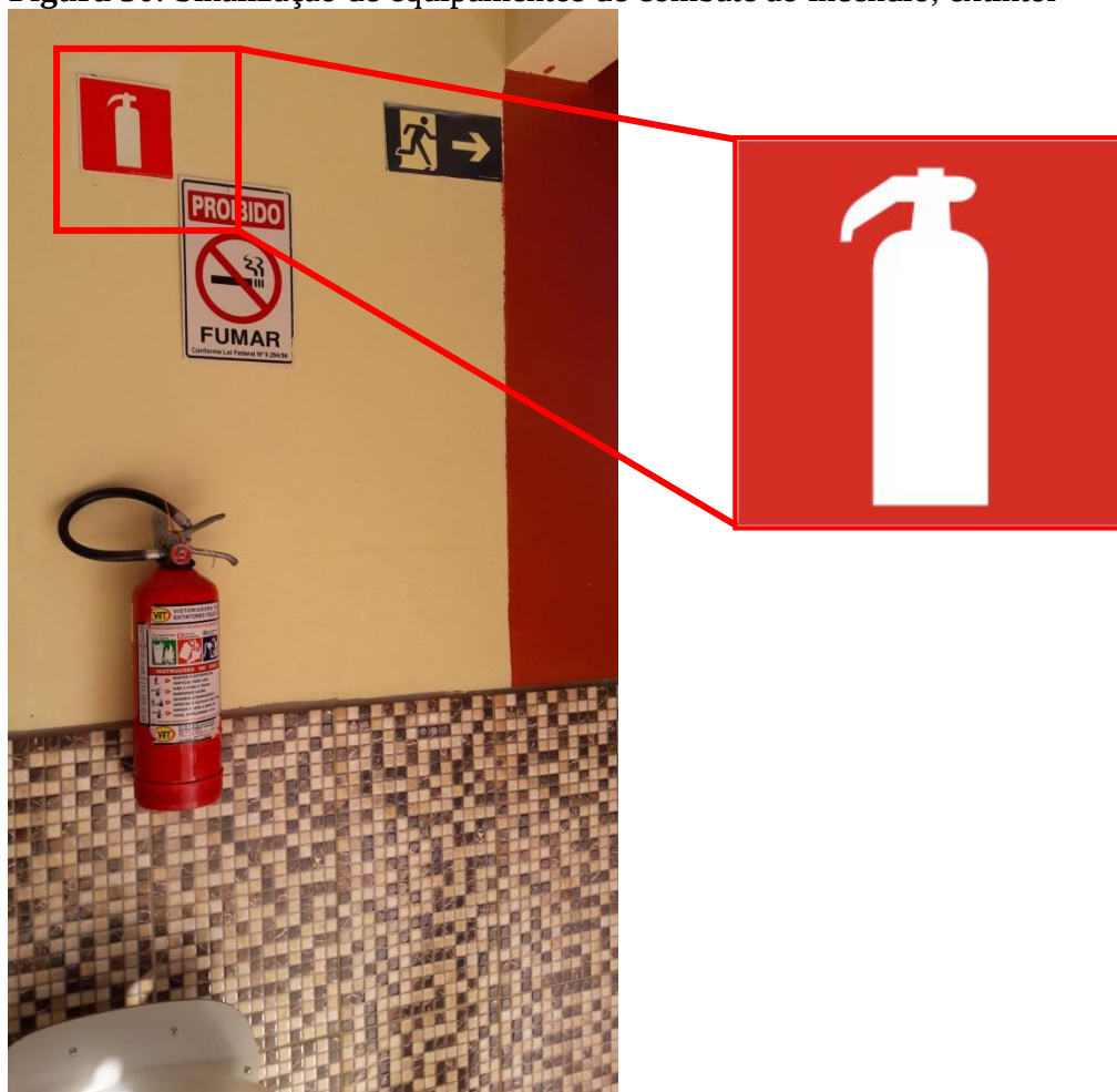
Figura 50: Sinalização de equipamentos de combate ao incêndio, extintor
