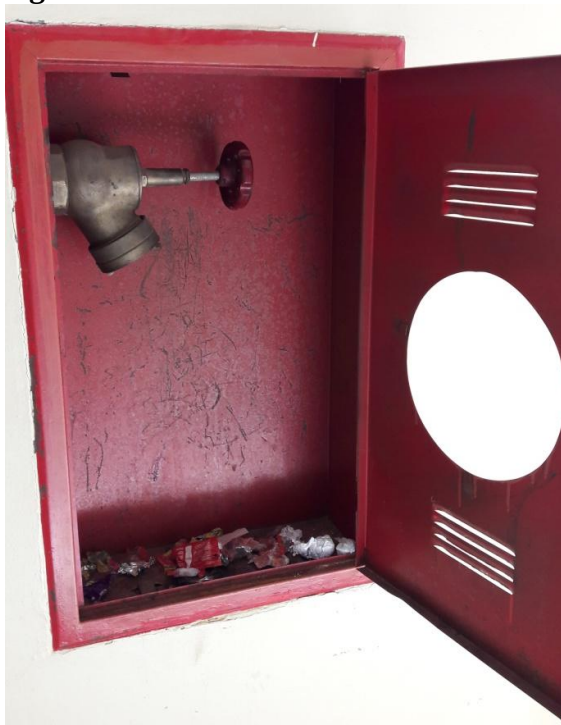
Figura 58: Hidrante do bloco II – térreo
