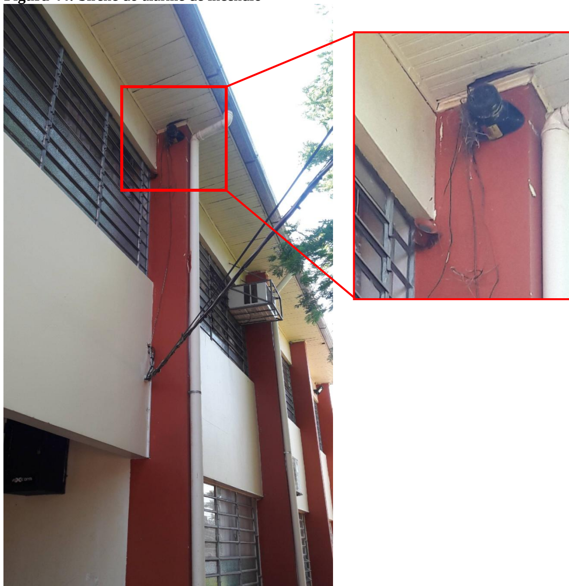
Figura 44: Sirene do alarme de incêndio
