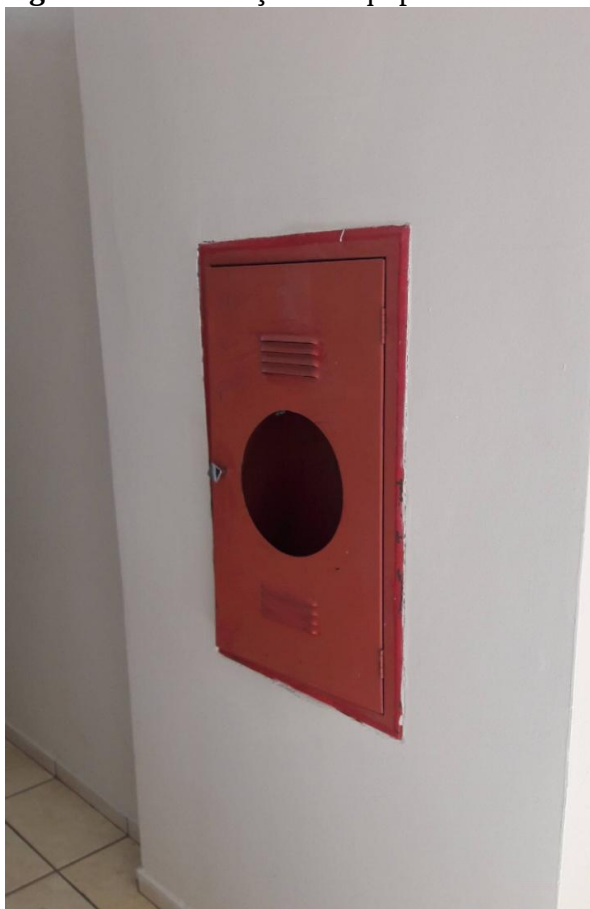
Figura 51: Sinalização de equipamentos de combate ao incêndio, hidrante
