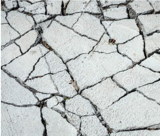
Figura 4: Quebra do concreto.
