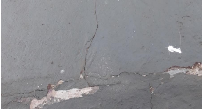
Figura 11: Destacamento e quebra do concreto.
