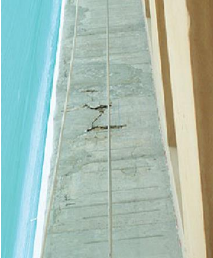
Figura 3: Destacamento do concreto.
