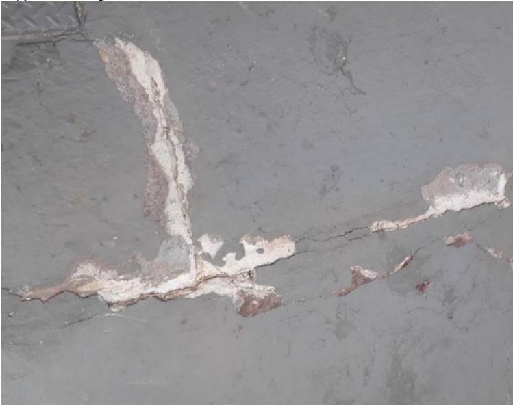
Figura 12: Quebra do concreto.
