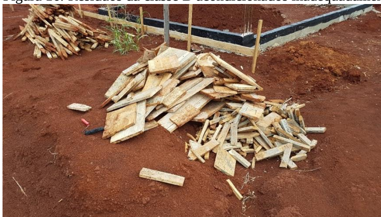
Figura 16: Resíduos da classe B acondicionados inadequadamente.
