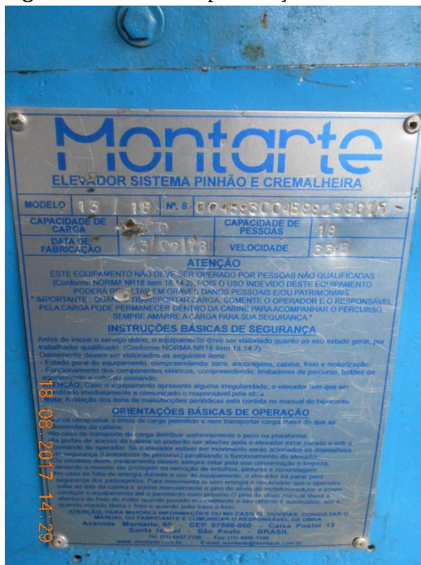
Figura 32: Placa de especificações do elevador.
