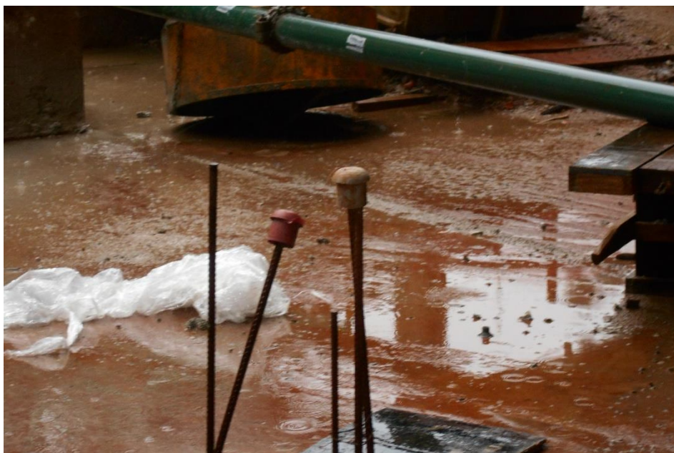
Figura 12: Pontas de vergalhões expostas no subsolo.
