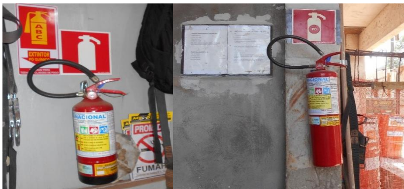
Figura 26: Detalhe de alguns extintores da obra.
