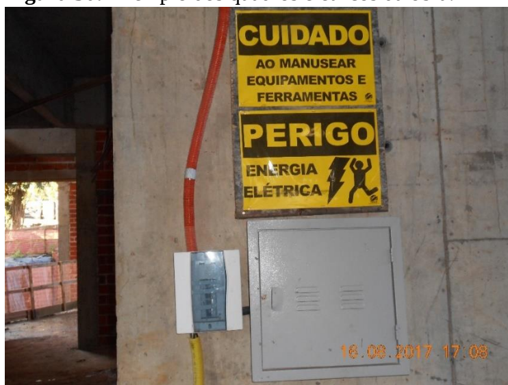
Figura 30: Exemplo dos quadros elétricos da obra.
