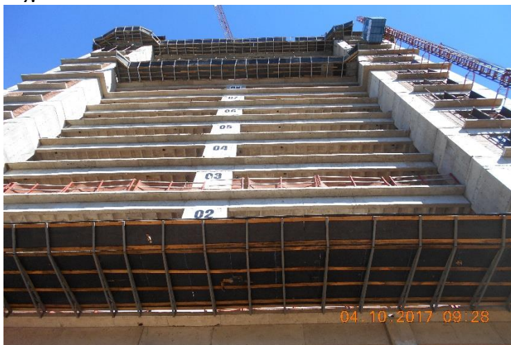
Figura 16: Detalhe da inexistência de tela fachadeira.
