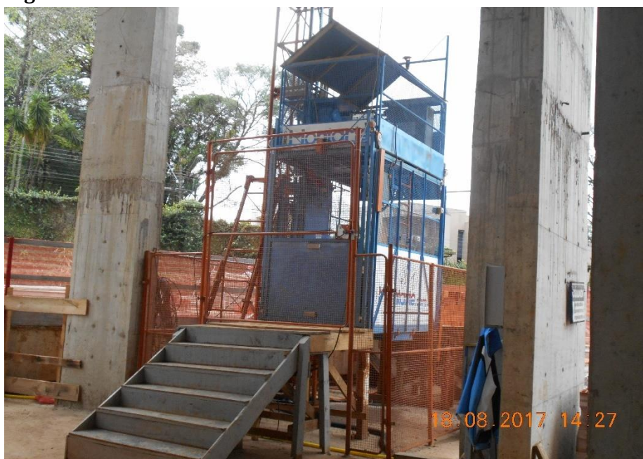
Figura 14: Detalhe do elevador da obra.
