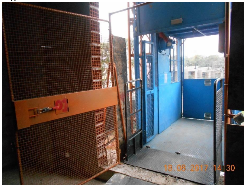
Figura 31: Cabine do elevador da obra com cancela e botoeira.
