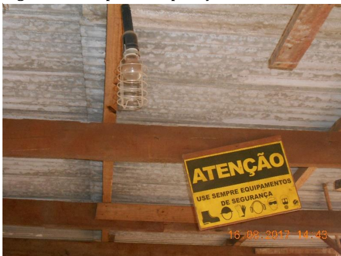
Figura 25: Lâmpada com proteção conforme NR-18 (2015)
