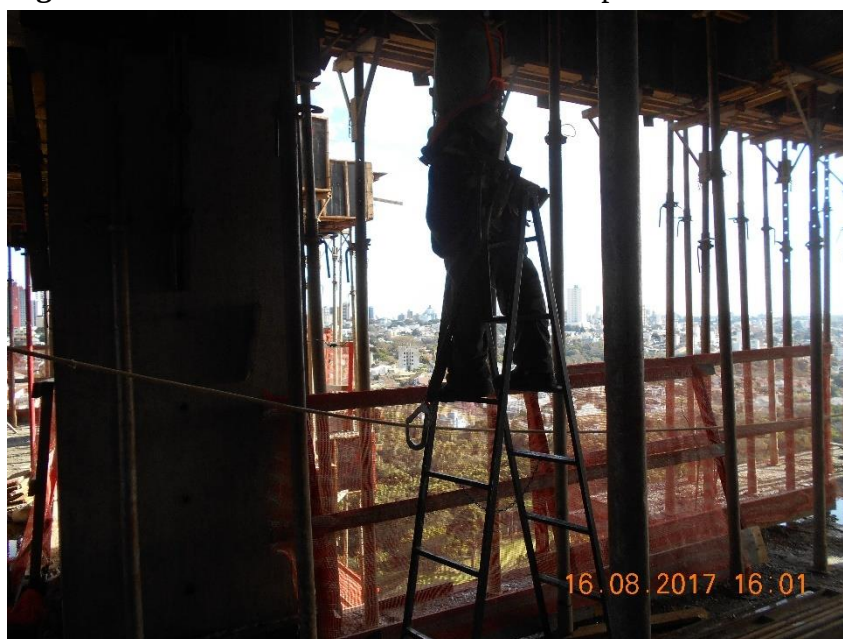
Figura 21: Detalhe de escada de abrir sem dispositivo de trava.
