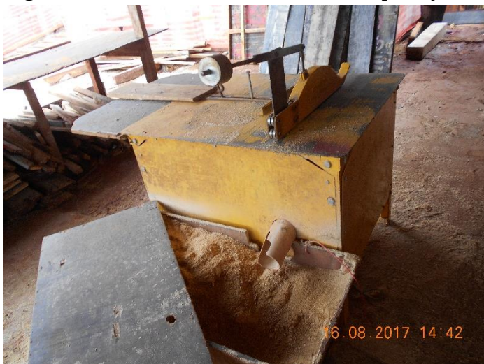
Figura 24: Detalhe da serra com coifa de proteção e coletor de serragem
