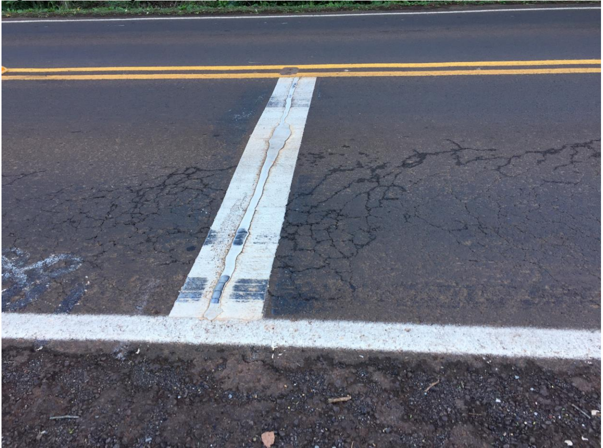
Figura 14: Trinca tipo “couro de jacaré”.
