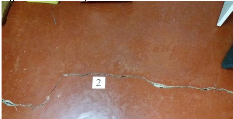
Figura 22: Fissura no piso – anomalia 2
