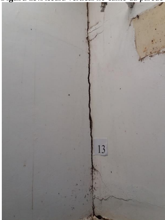
Figura 29: Fissura vertical no canto da parede – anomalia 13
