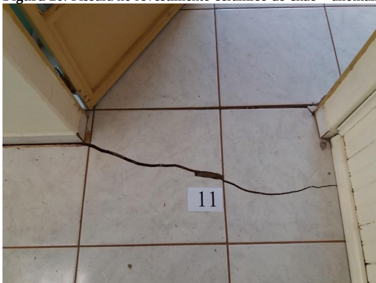
Figura 26: Fissura no revestimento cerâmico do chão – anomalia 11
