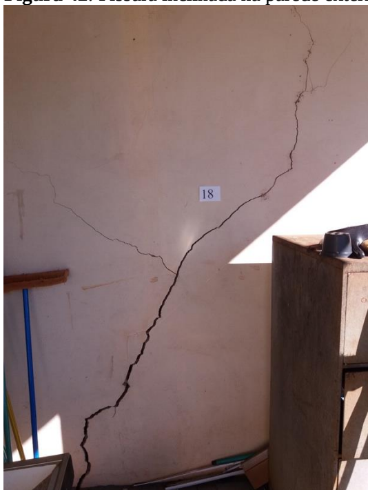
Figura 42: Fissura inclinada na parede externa – anomalia 18
