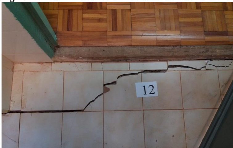
Figura 27: Fissura no revestimento cerâmico do chão – anomalia 12
