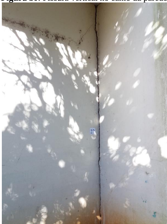
Figura 30: Fissura vertical no canto da parede – anomalia 22
