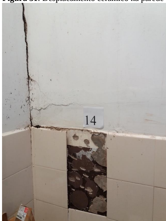
Figura 31: Desplacamento cerâmico na parede – anomalia 14
