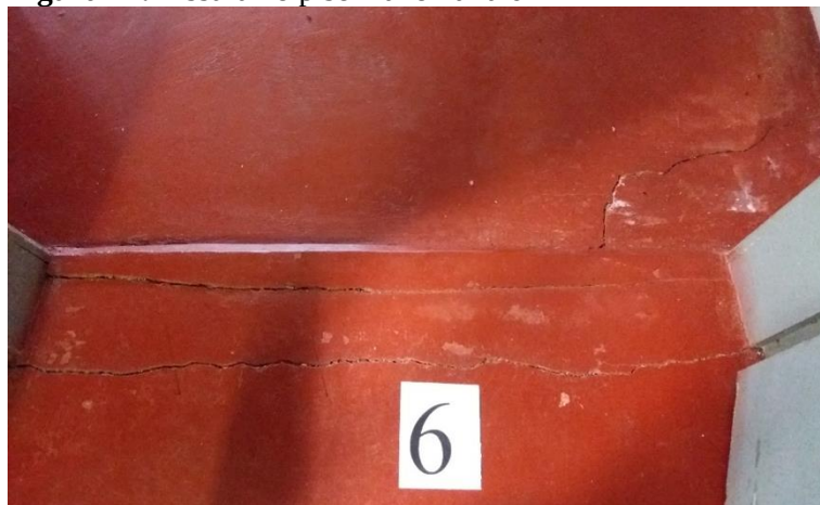
Figura 24: Fissura no piso – anomalia 6
