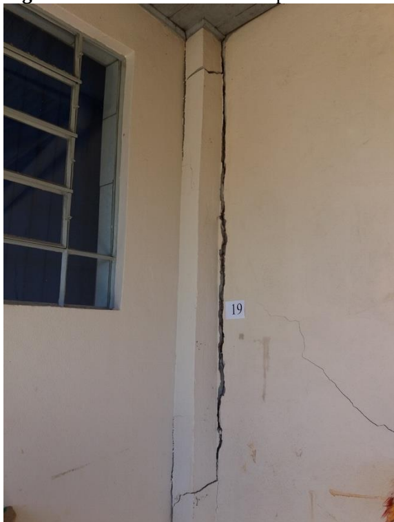
Figura 34: Fissura na vertical na parede externa – anomalia 19
