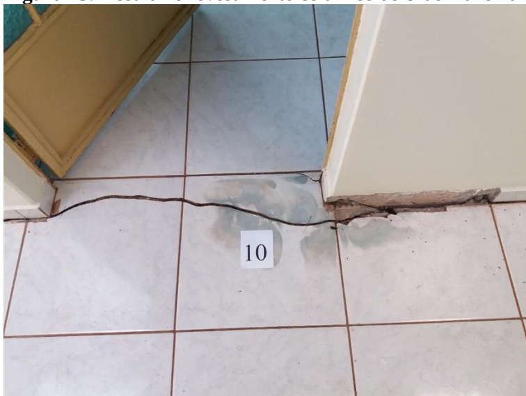
Figura 25: Fissura no revestimento cerâmico do chão – anomalia 10
