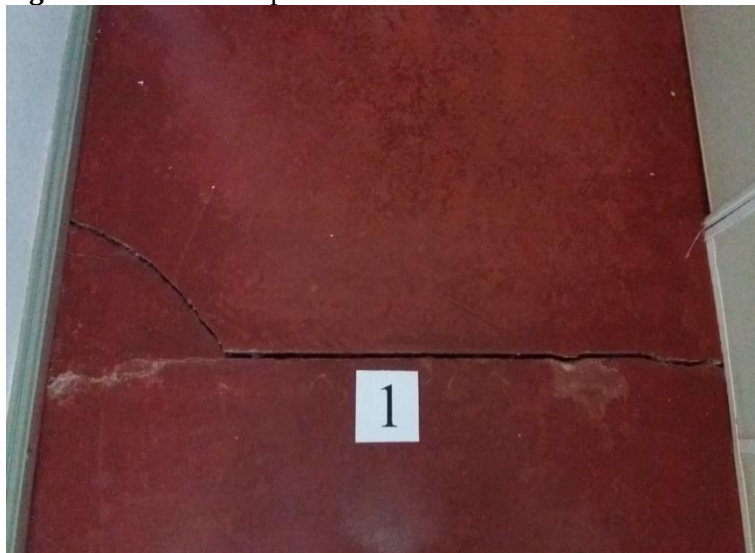
Figura 21: Fissura no piso – anomalia 1
