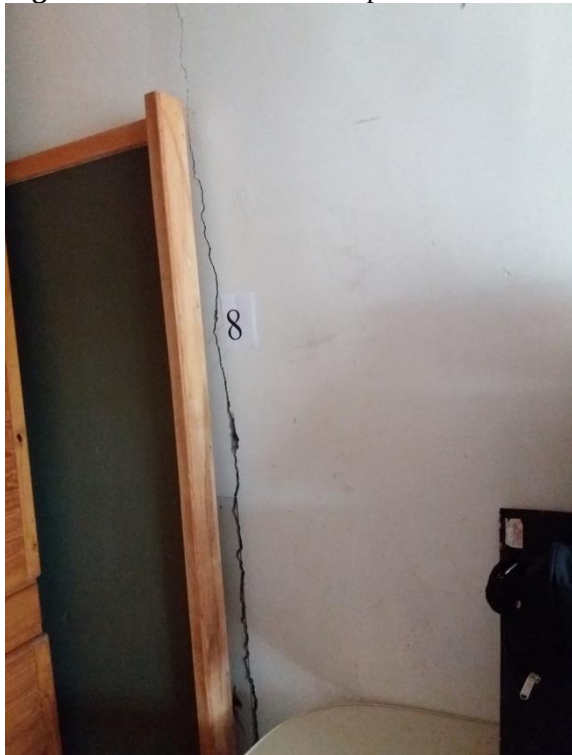
Figura 37: Fissura vertical na parede – anomalia 8
