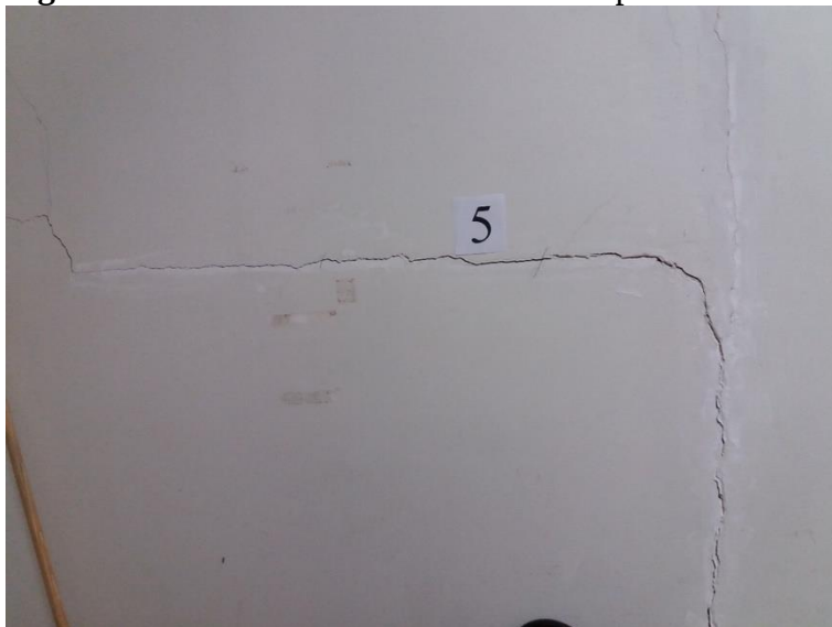
Figura 35: Fissura vertical e horizontal na parede – anomalia 5
