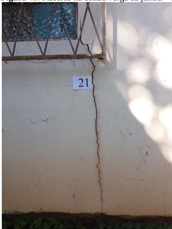
Figura 40: Fissuras na contra verga da janela – anomalia 21
