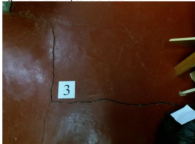
Figura 23: Fissura no piso – anomalia 3
