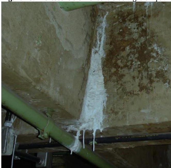
Figura 15: Eflorescência em encontro de vigas em pavimento de garagem
