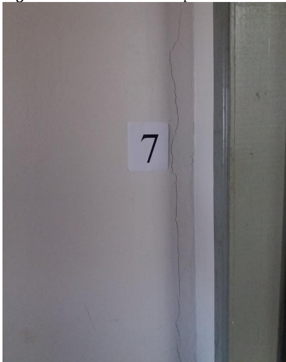
Figura 36: Fissura vertical na parede – anomalia 7
