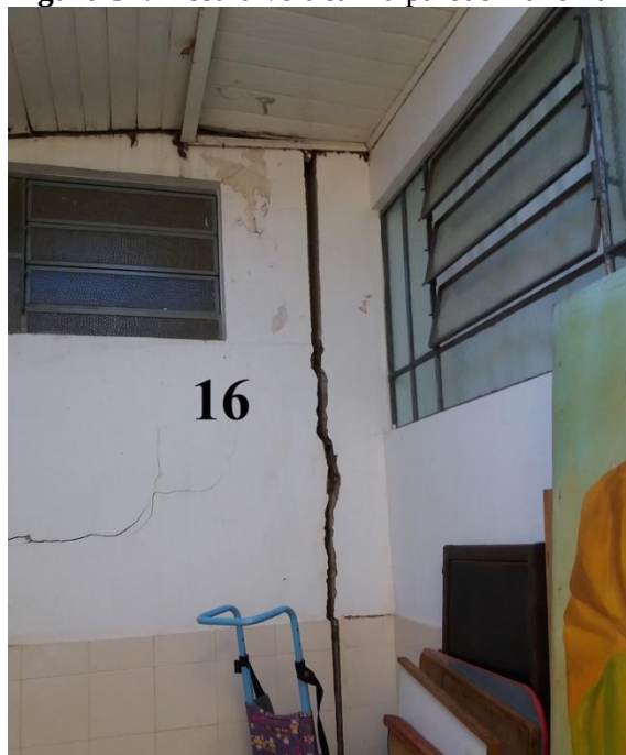
Figura 32: Fissura vertical na parede – anomalia 16
