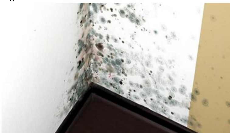
Figura 16: Bolor na estrutura de concreto
