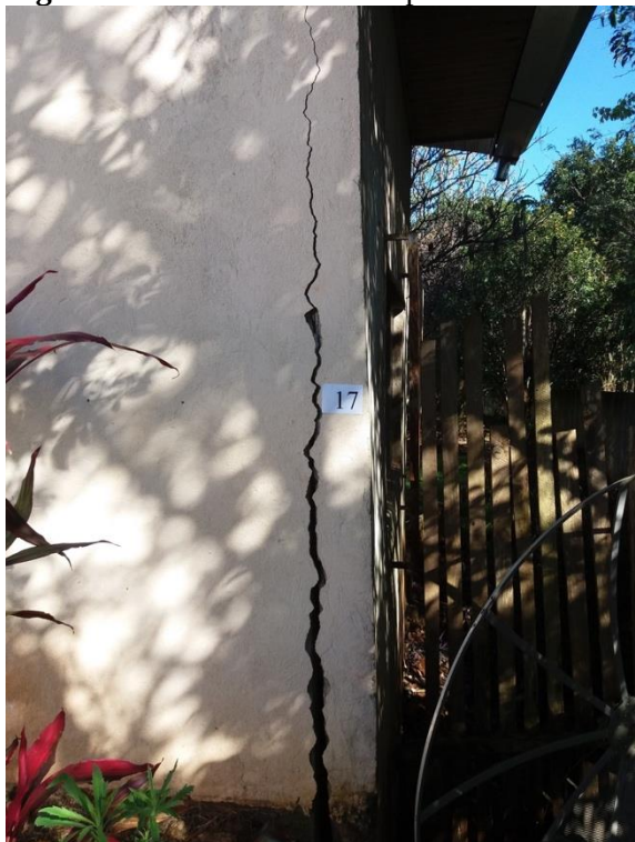
Figura 33: Fissura vertical na parede externa – anomalia 17
