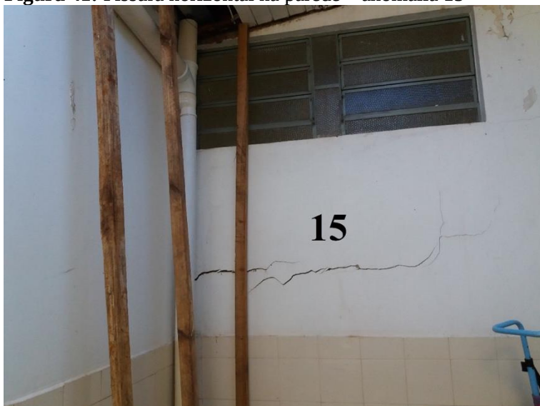
Figura 41: Fissura horizontal na parede – anomalia 15
