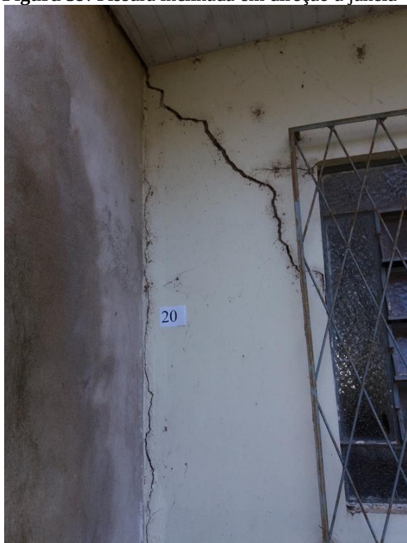
Figura 39: Fissura inclinada em direção a janela – anomalia 20
