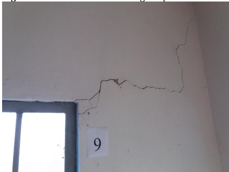
Figura 38: Fissura inclinada na verga da porta – anomalia 9
