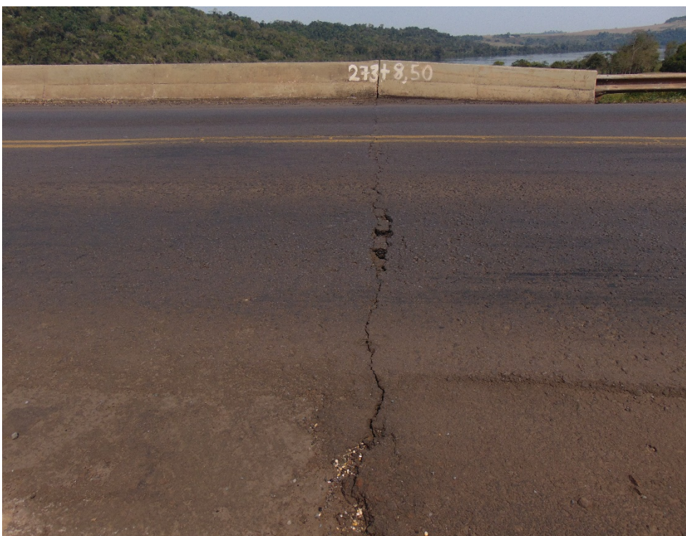
Figura 20: Trincas nos acessos
