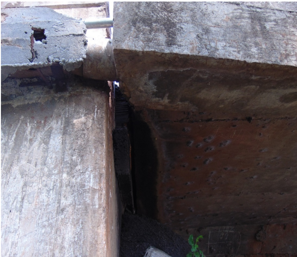
Figura 19: Infiltração nos encontros
