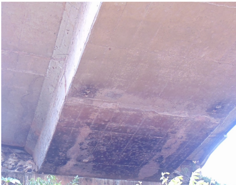
Figura 18: Umidade na laje principal.
