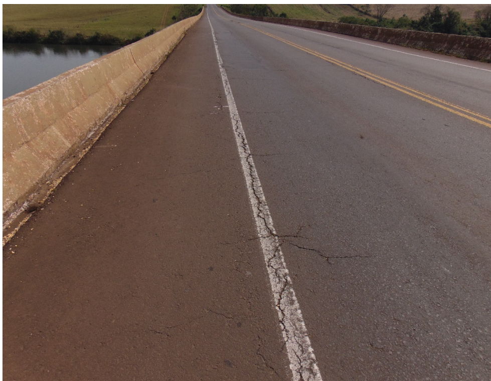
Figura 21: Trincas na pista de rolamento
