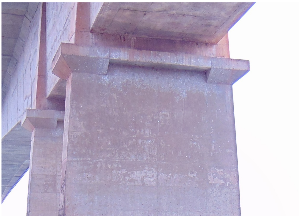
Figura 17: Lixiviação na aduela de arranque 1.
