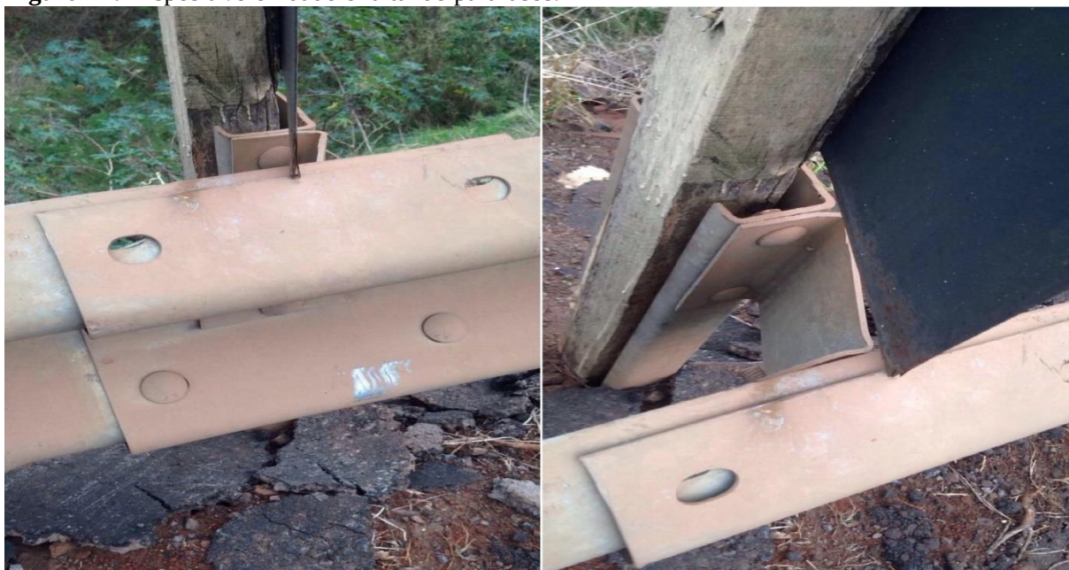
Figura 14: Dispositivo oxidado e faltando parafusos.
