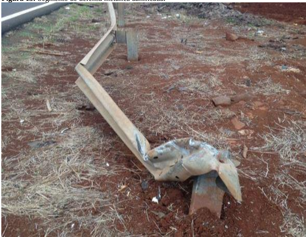
Figura 13: Segmento de defesa metálica danificada.
