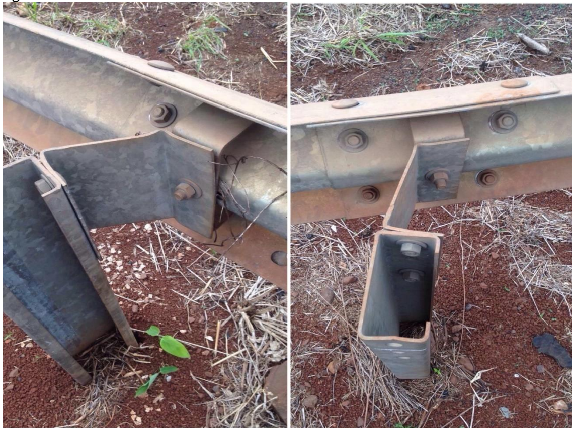
Figura 10: Lâmina oxidada e atenuadores danificados.
