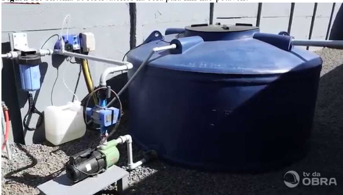
Figura 11: Sistema de reservatórios na obra para fins não-potáveis.
