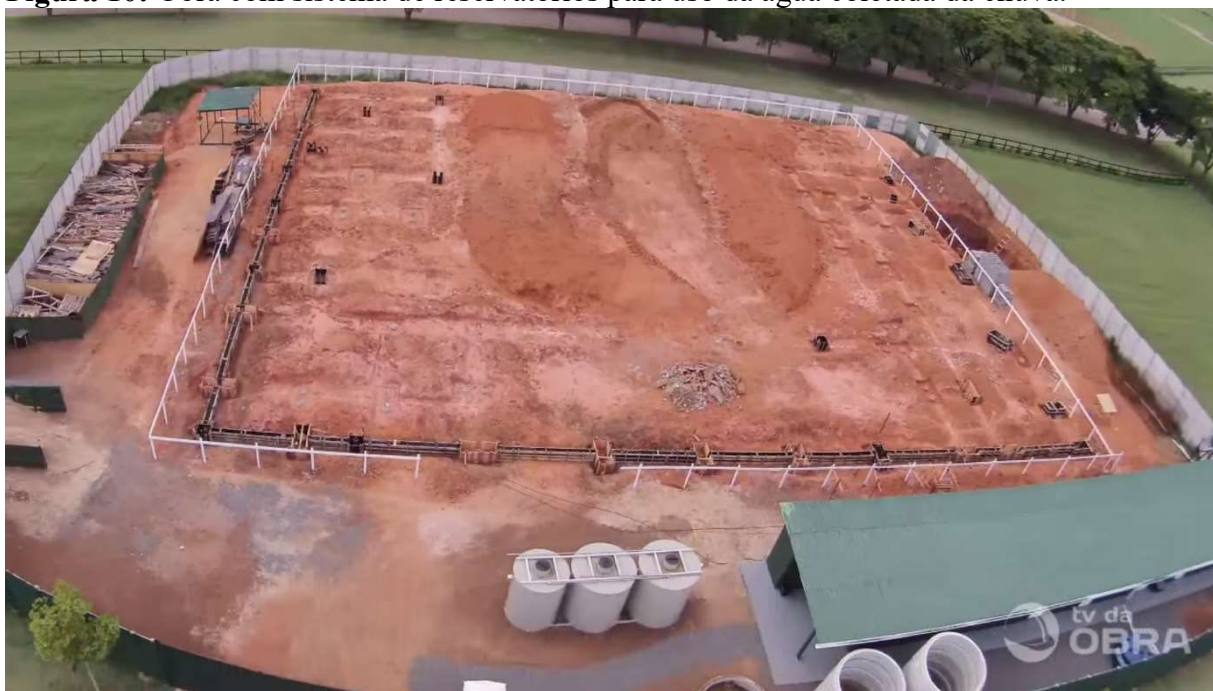
Figura 10: Obra com sistema de reservatórios para uso da água coletada da chuva.
