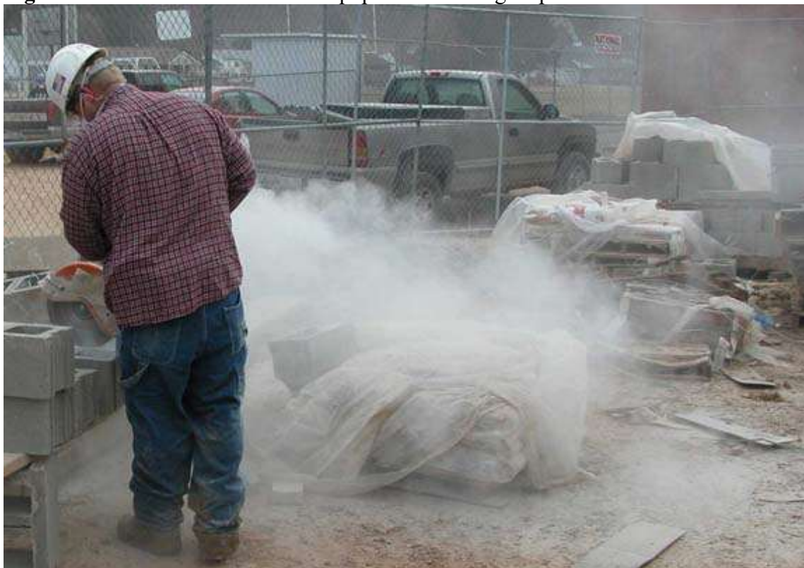
Figura 05: Trabalhador utilizando equipamento onde gera poeira.
