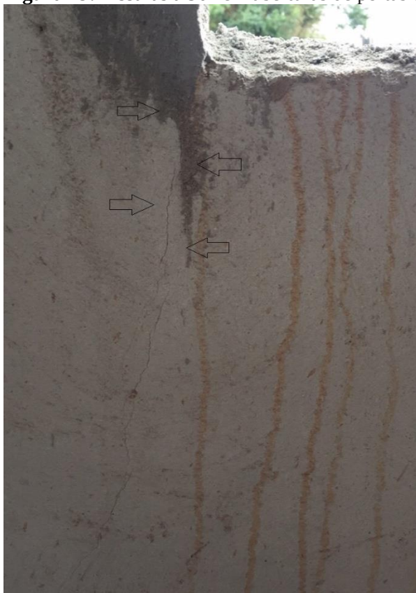
Figura 19: Fissuras a 90° em aberturas de portas e janelas.
