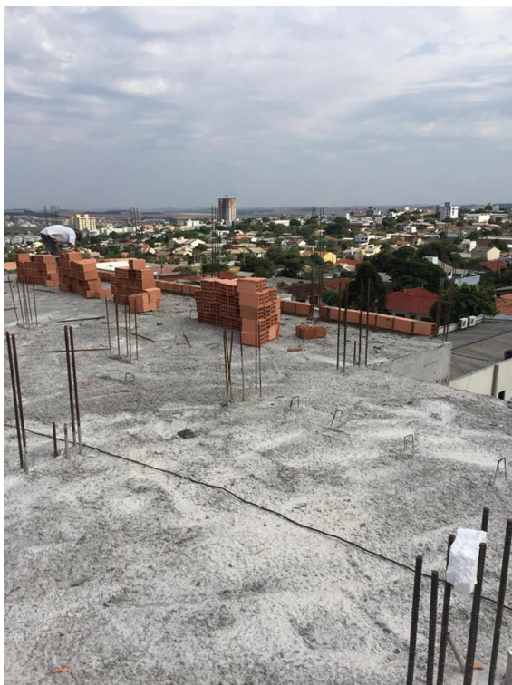
Figura 7 – Periferia desprotegida por guarda-corpo.
