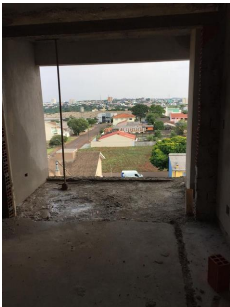
Figura 5 – Sacada sem guarda-corpo.
