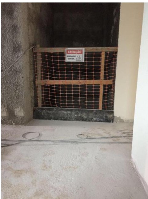
Figura 11 – Fechamento da caixa de elevador dentro dos padrões exigidos na norma.
