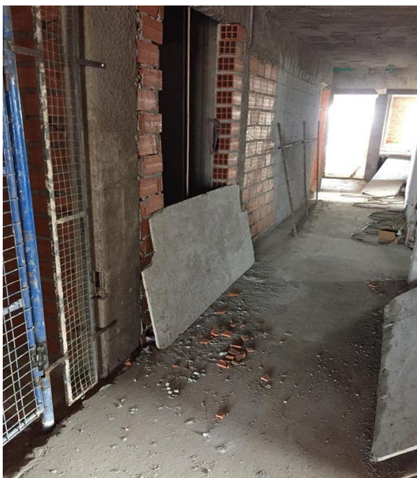
Figura 6 – Falta de proteção contra queda na caixa de elevador.
