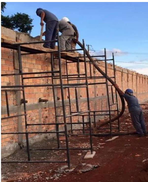
Figura 10 – Andaime em desacordo com a norma e funcionários sem o cinto de segurança.
