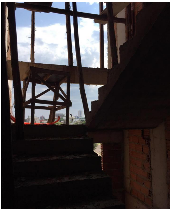
Figura 8 – Falta de manutenção do guarda-corpo.
