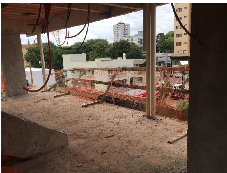
Figura 4 – Falta de manutenção do guarda-corpo.
