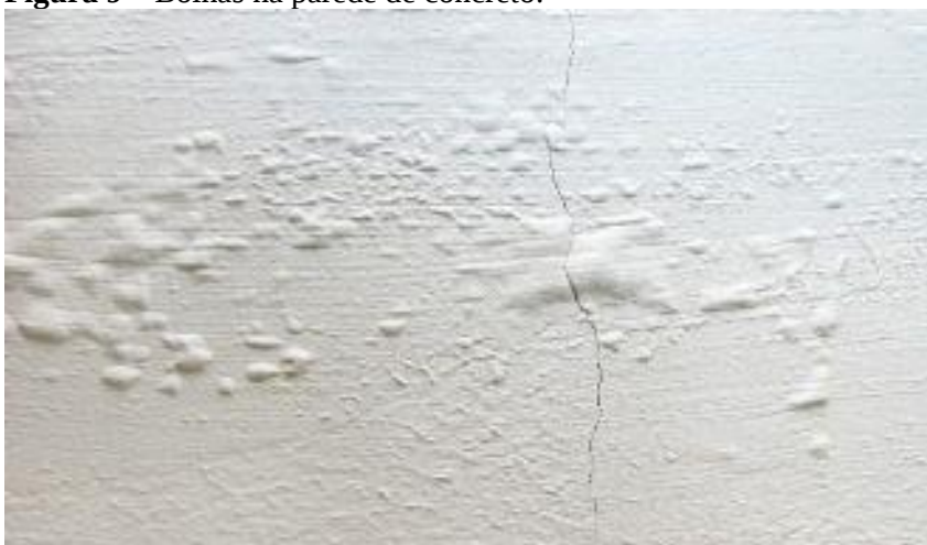
Figura 9 – Bolhas na parede de concreto.
