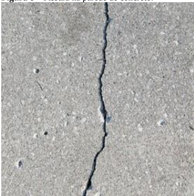
Figura 8 – Fissura na parede de concreto.
