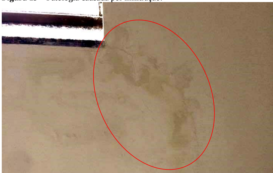
Figura 19 – Patologia causada por infiltração.
