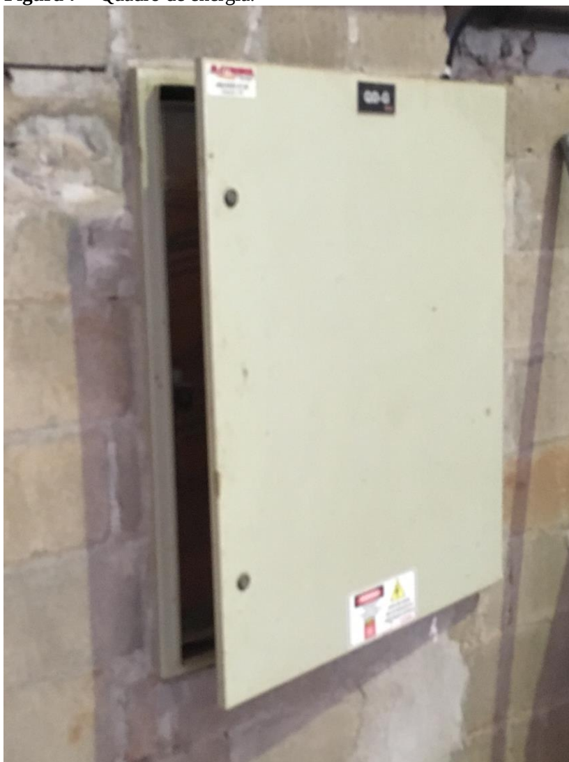
Figura 7 – Quadro de energia.
