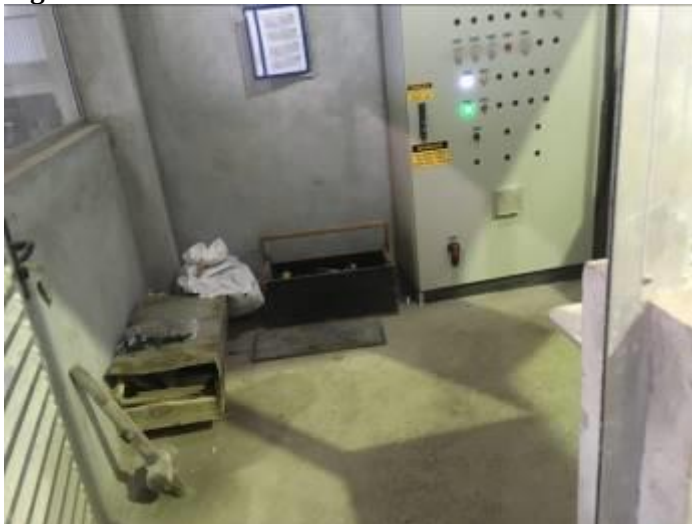
Figura 21 – Ferramentas em local incorreto.
