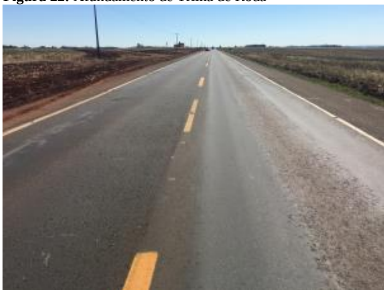
Figura 22: Afundamento de Trilha de Roda
