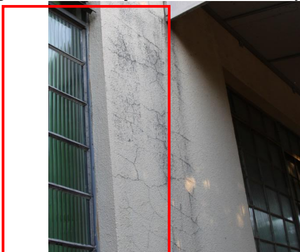
Figura 19: Fissuras mapeadas na fachada da edificação
