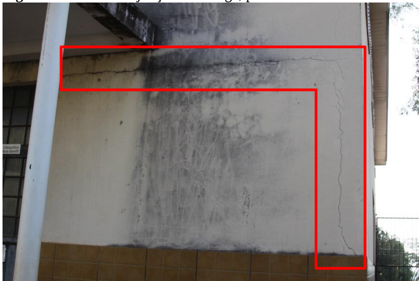
Figura 22: Fissura na junção entre viga, pilar e alvenaria
