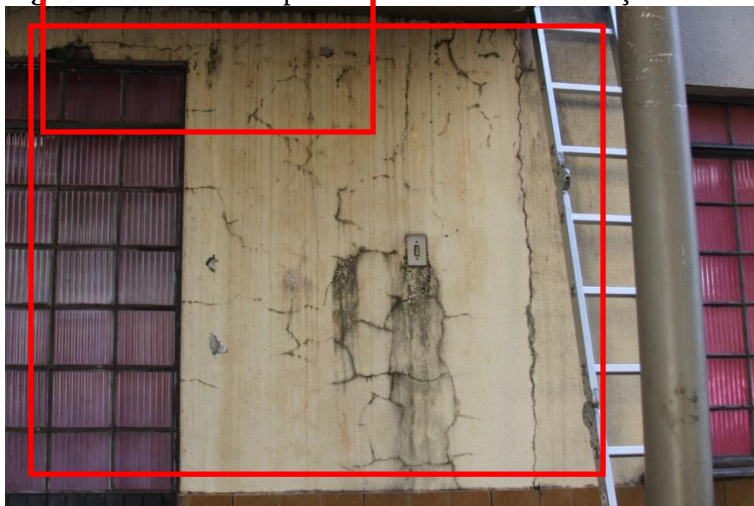
Figura 20: Fissuras mapeadas na fachada da edificação
