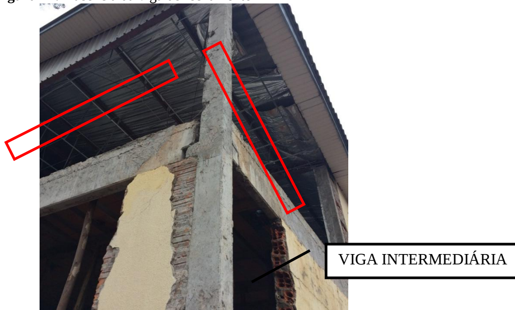
Figura 27: Ausência da viga de fechamento
