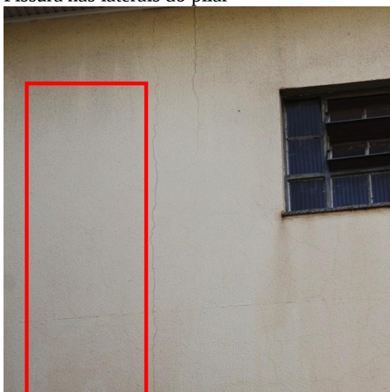
Figura 23: Fissura nas laterais do pilar
