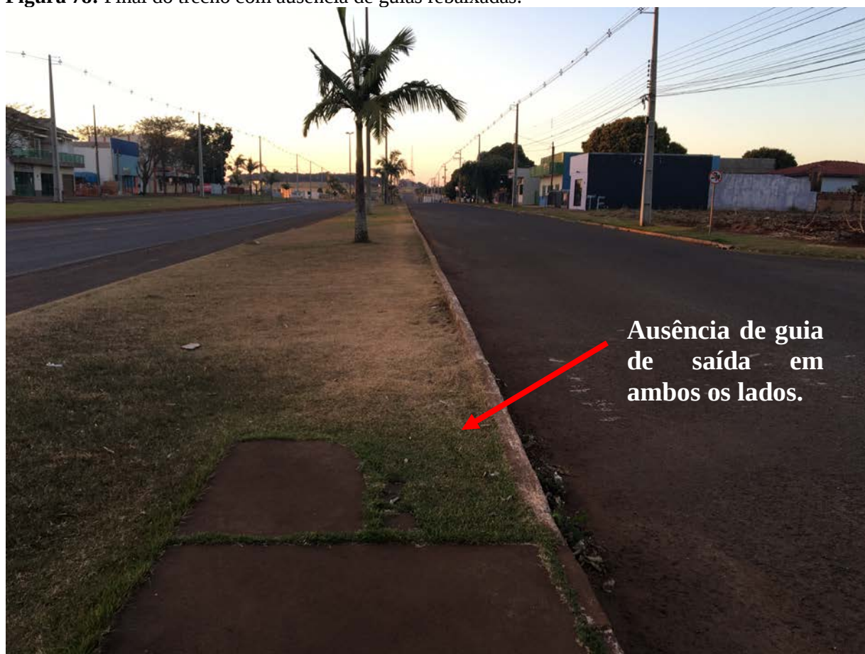
Figura 78: Final do trecho com ausência de guias rebaixadas.
