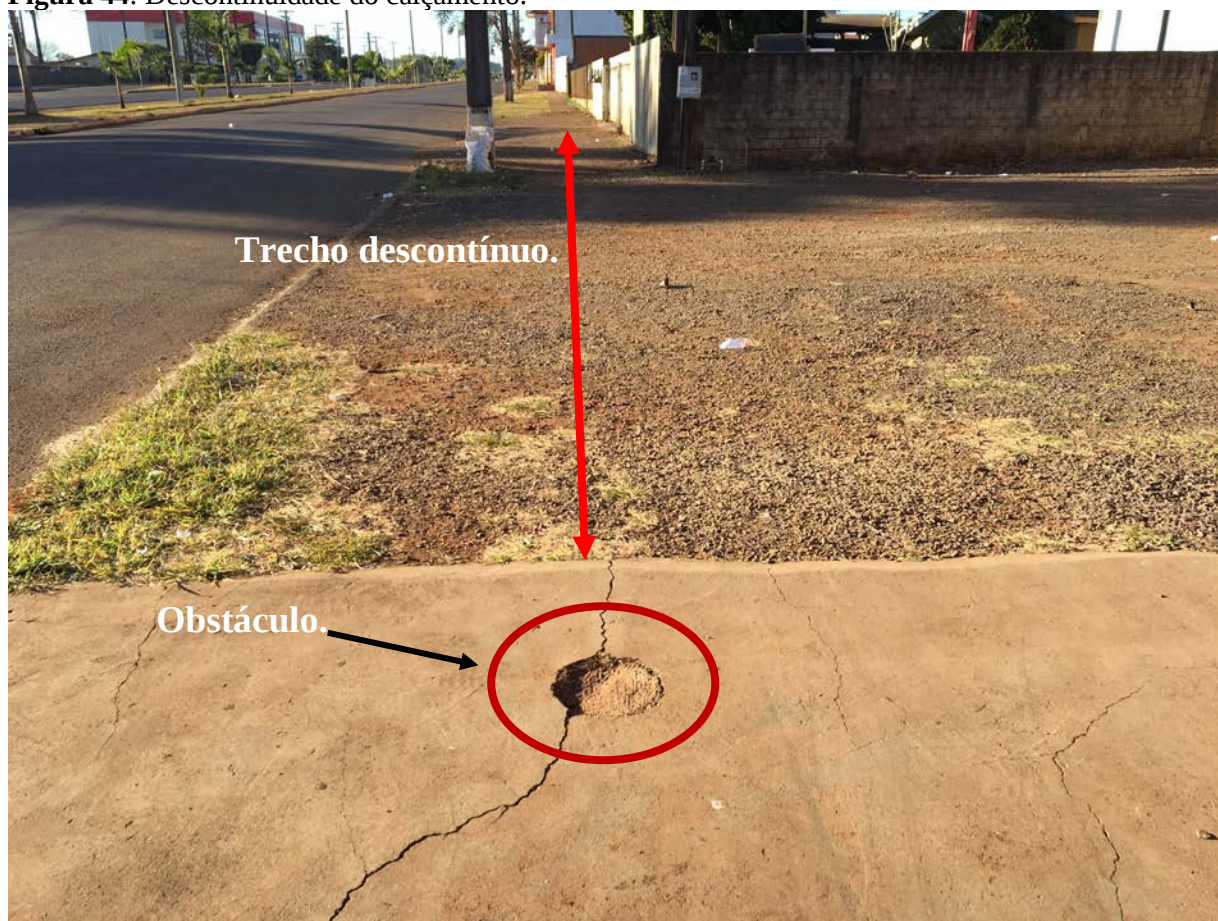
Figura 44: Descontinuidade do calçamento.
