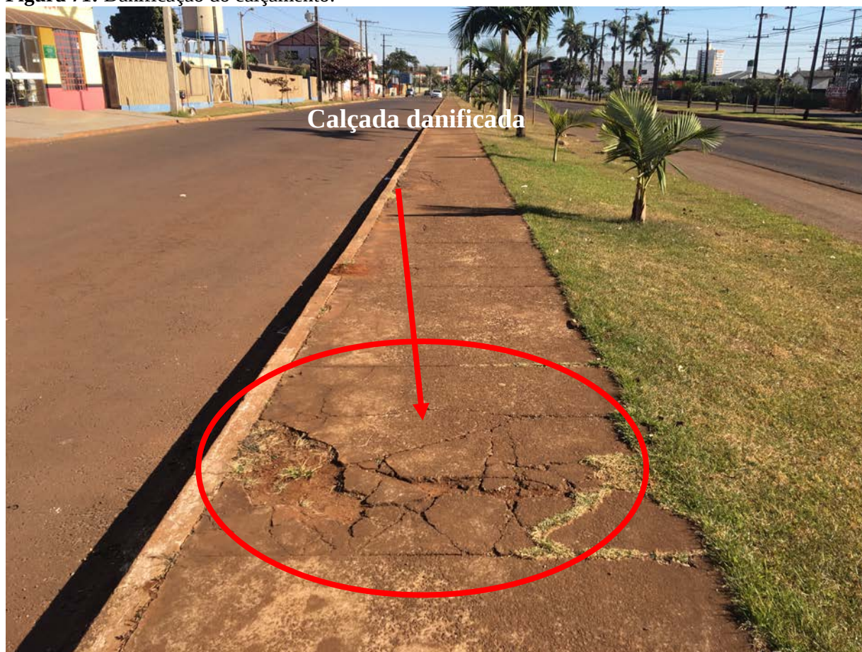
Figura 71: Danificação do calçamento.
