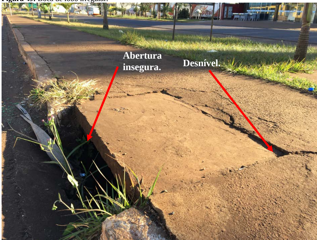
Figura 49: Boca de lobo irregular.
