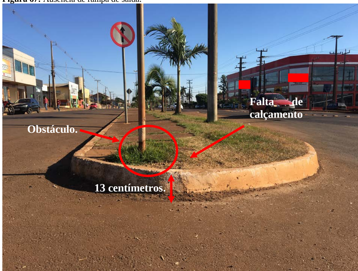
Figura 67: Ausência de rampa de saída.
