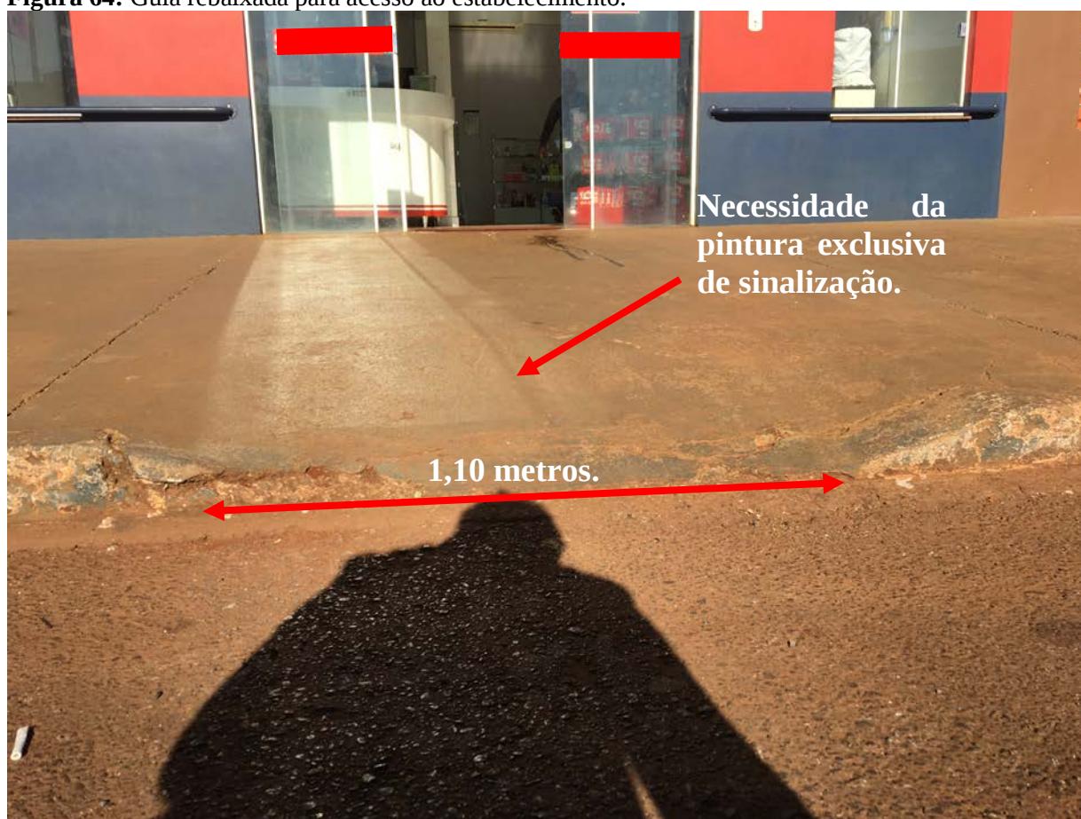
Figura 64: Guia rebaixada para acesso ao estabelecimento.
