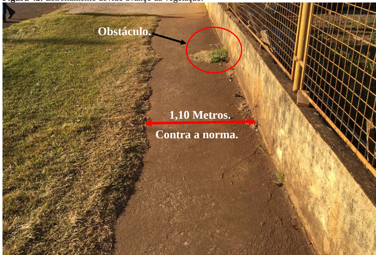
Figura 42: Estreitamento devido avanço da vegetação.
