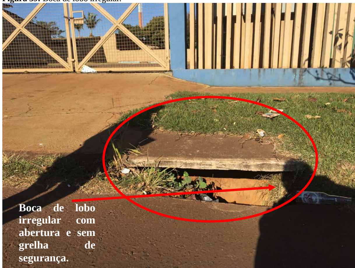
Figura 59: Boca de lobo irregular.
