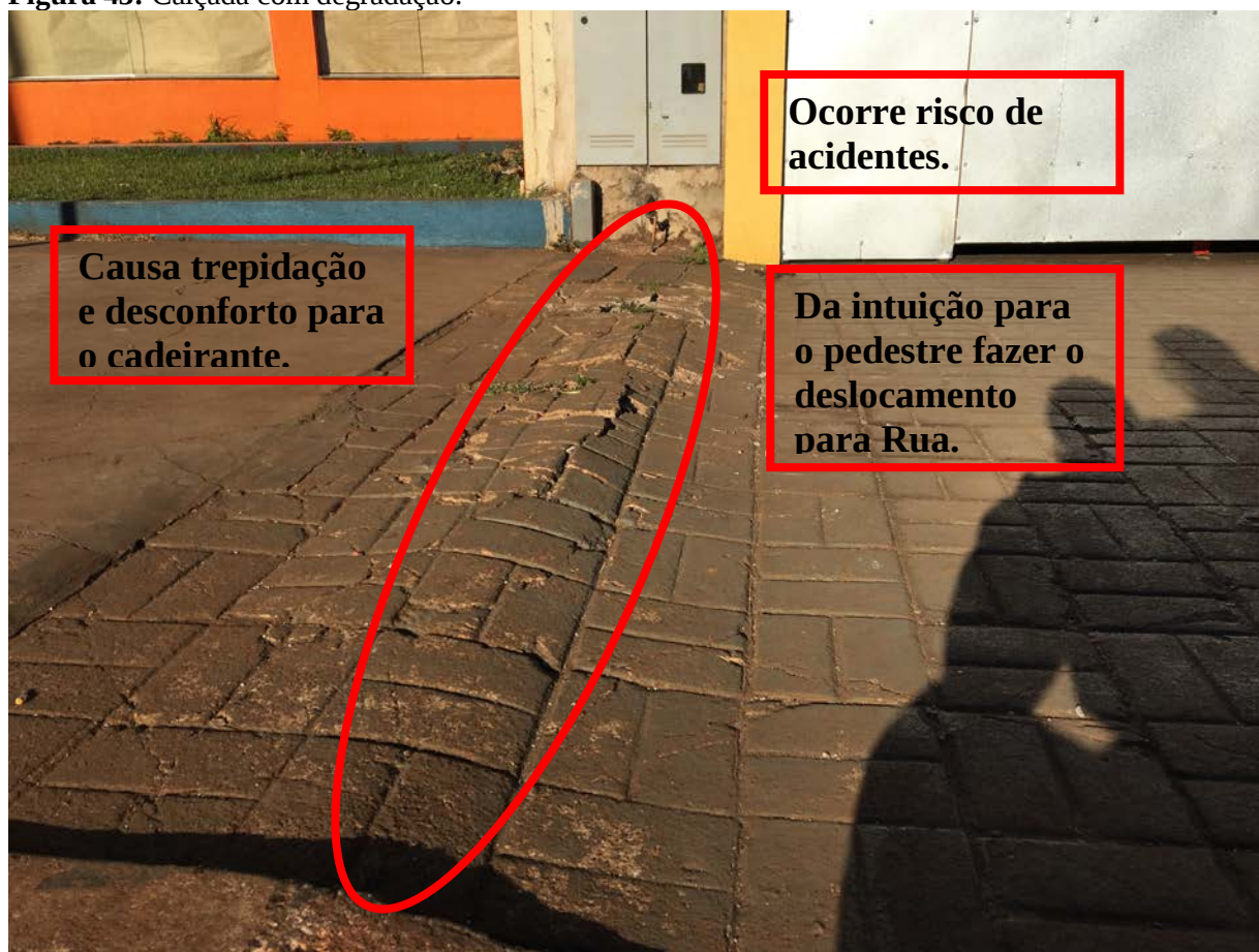
Figura 43: Calçada com degradação.
