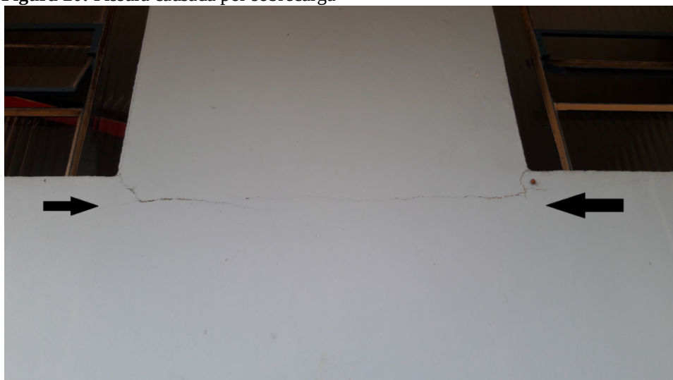
Figura 20: Fissura causada por sobrecarga
