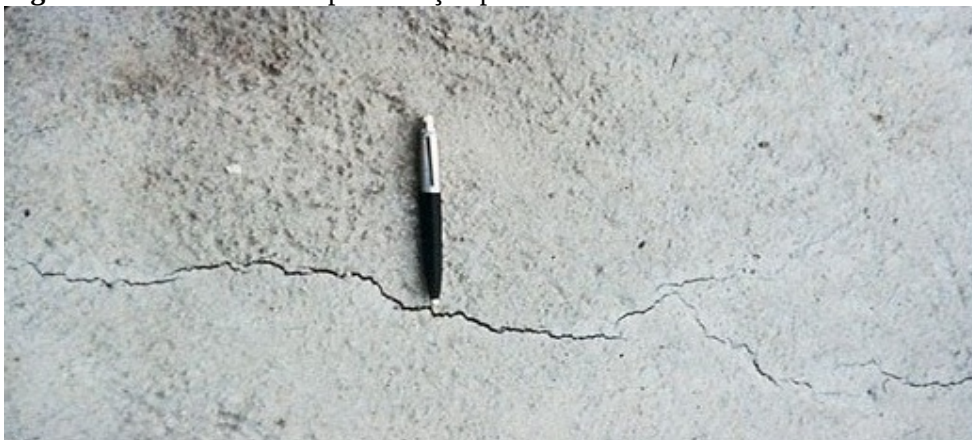
Figura 8: Fissura causada por retração plástica
