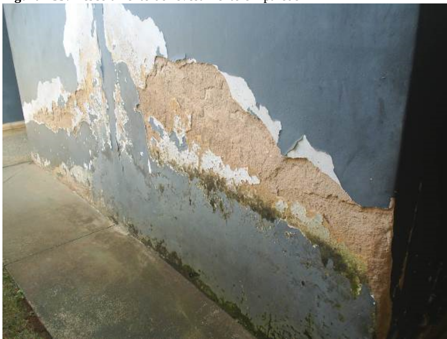
Figura 135: Descolamento do revestimento em parede
