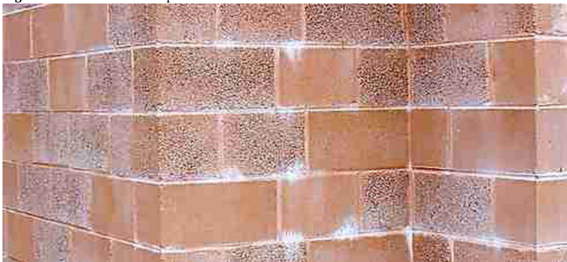
Figura 13: Eflorescência em parede
