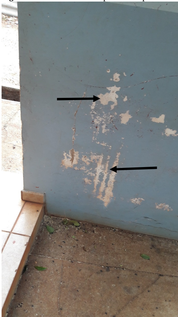
Figura 28: Descolamento de pintura em parede
