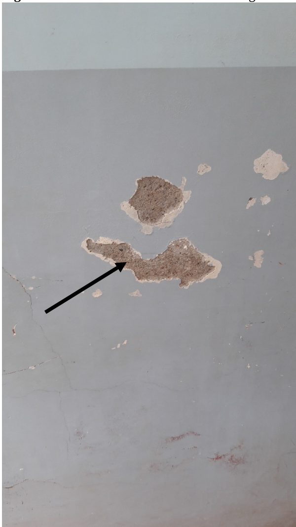
Figura 29: Descolamento do revestimento argamassado
