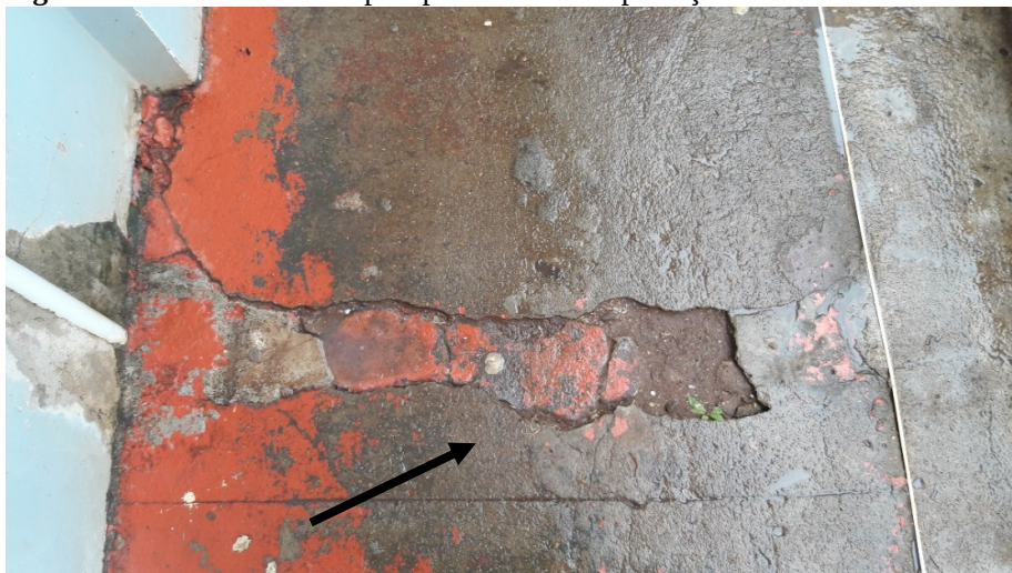
Figura 30: Afundamento do piso por falta de compactação do solo
