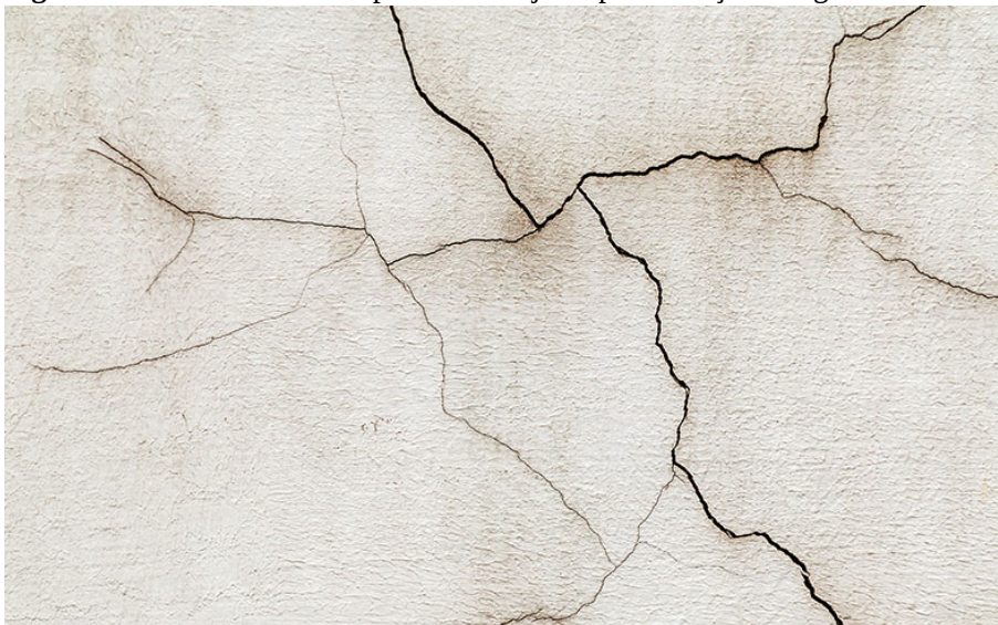
Figura 9: Trincas devido à expansão dos tijolos por absorção da água
