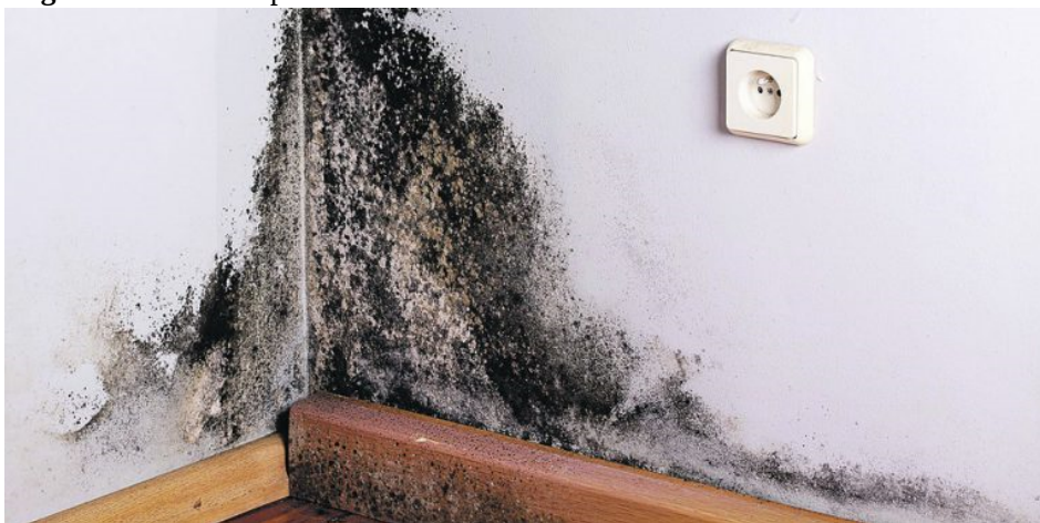
Figura 11: Bolor na parede
