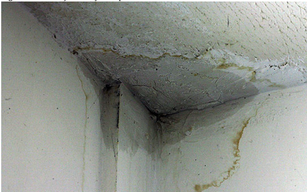
Figura 12: Infiltrações na laje e na parede
