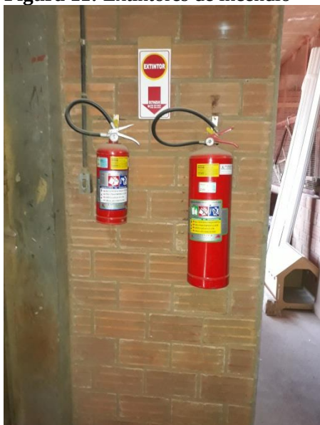
Figura 11: Extintores de incêndio
