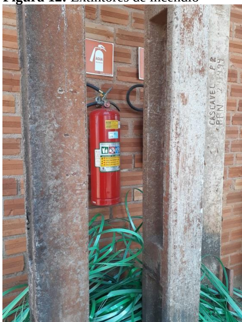
Figura 12: Extintores de incêndio
