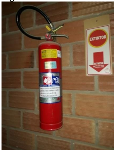
Figura 10: Extintor de incêndio
