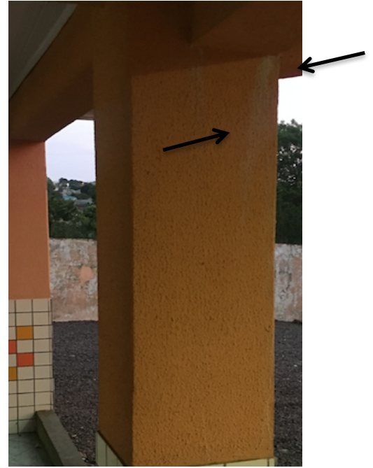
Eflorescência no pilar
