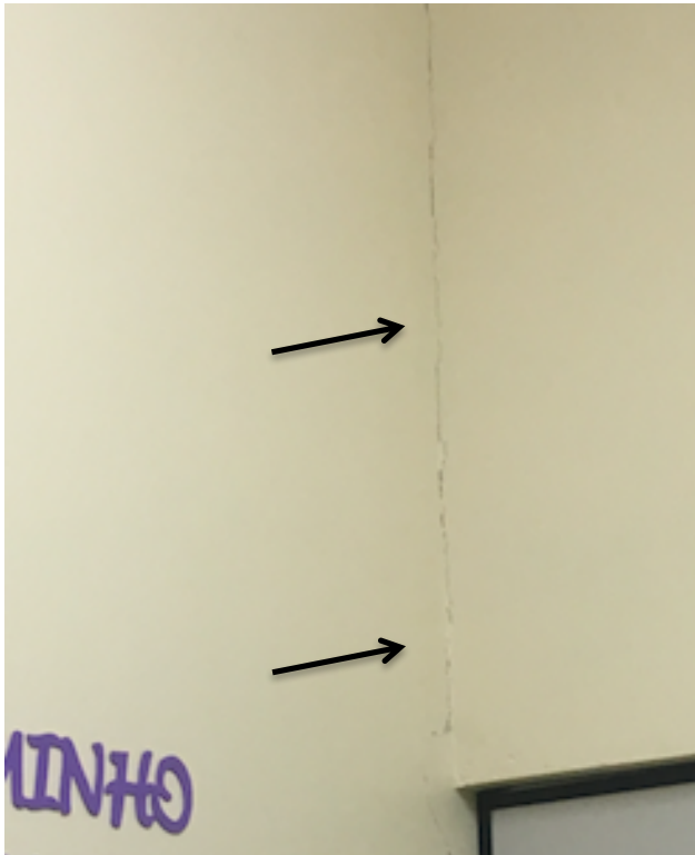
Fissuras devido a sobrecarga
