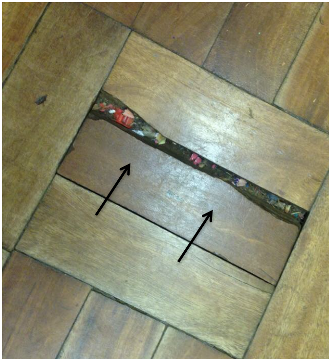
Descolamento do piso
