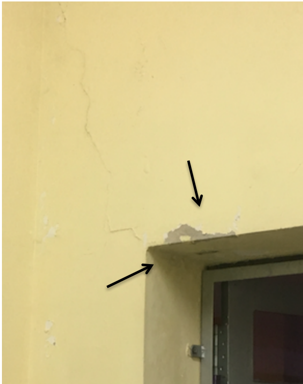
Fissuras devido a sobrecarga.
