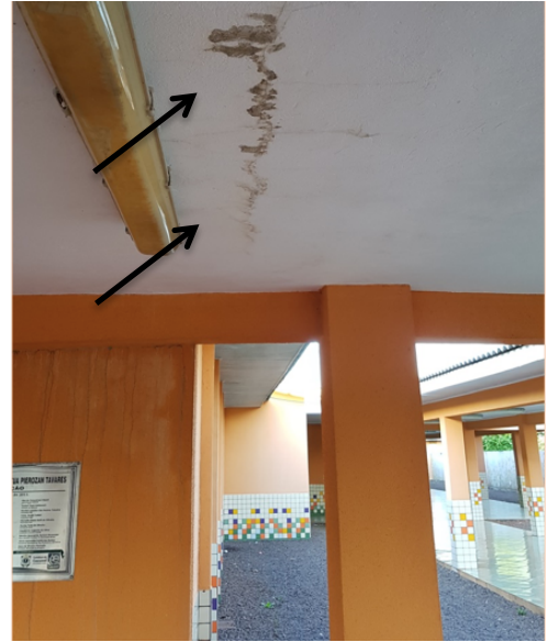
Infiltração e bolor na laje
