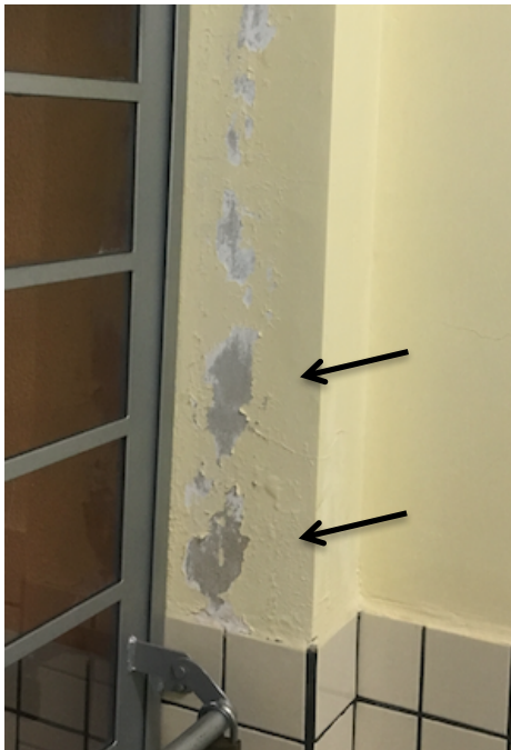
Descolamento da pintura área interna
