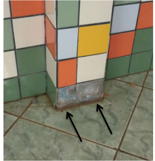
Descolamento do revestimento cerâmico
