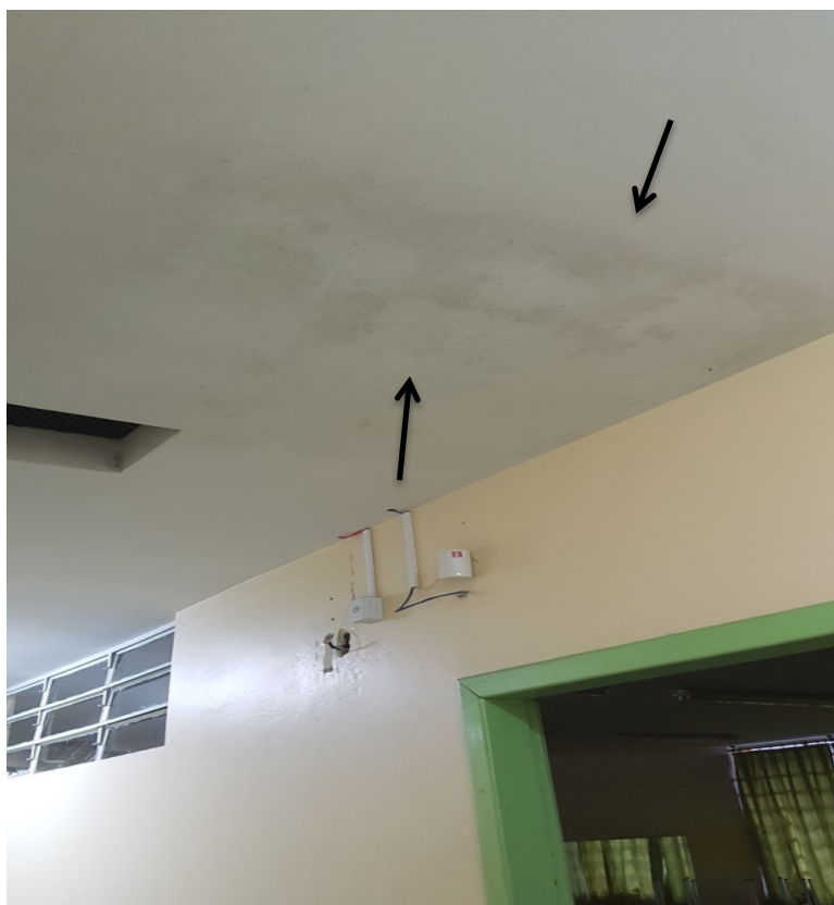
Figura 15: Bolor decorrente de infiltração
