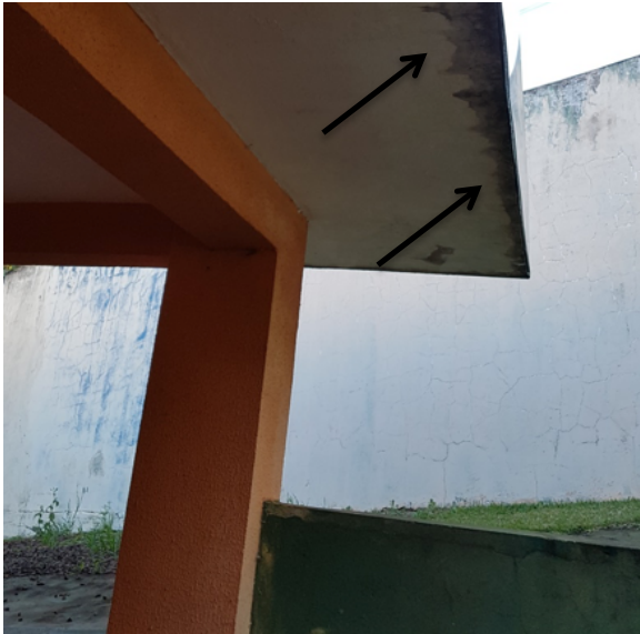
Infiltração e bolor na devida a umidade da chuva
