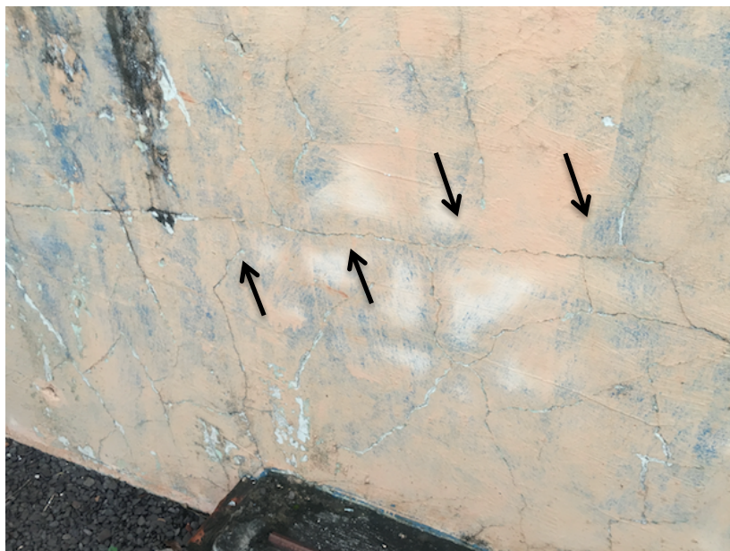
Figura 17: Fissura devido a movimentação higroscópica
