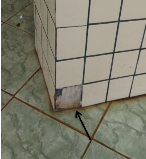
Descolamento do revestimento cerâmico
