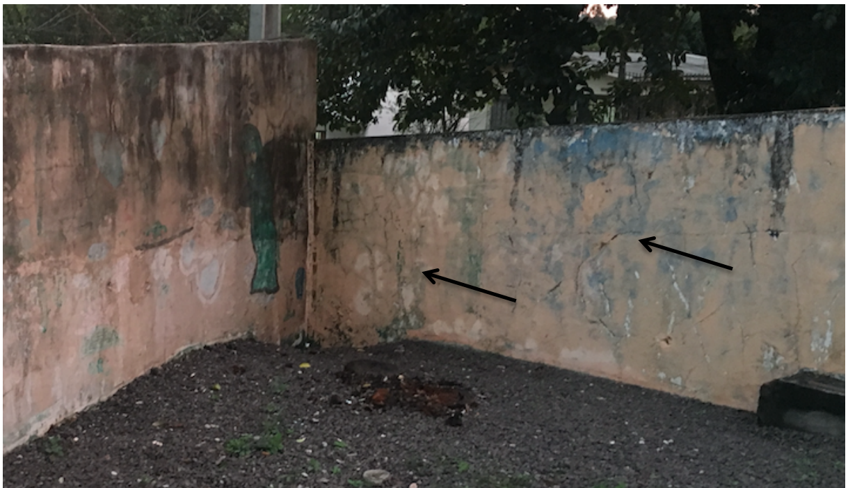
Muro lado interna da escola com fissuras por movimentação higroscópica
