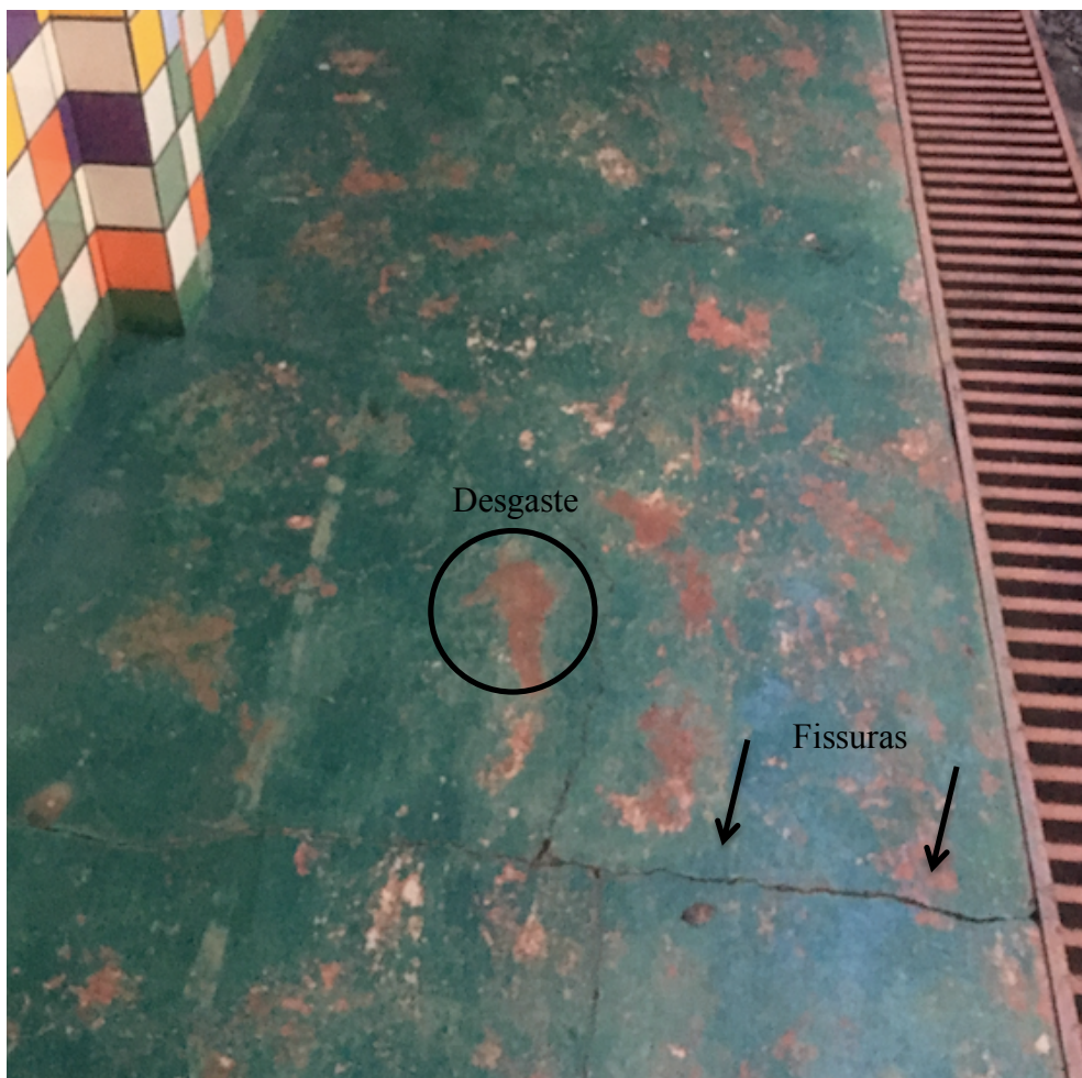
Figura 26: Desgaste do Piso
