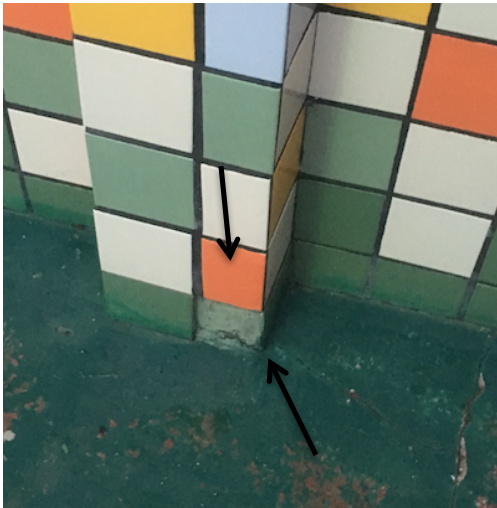
Descolamento do revestimento cerâmico
