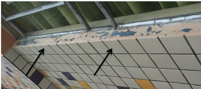
Descolamento da pintura área externa
