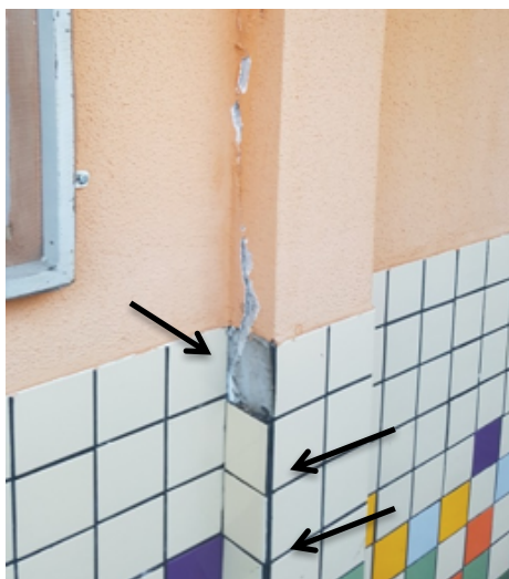
Figura 14: Descolamento do revestimento cerâmico
