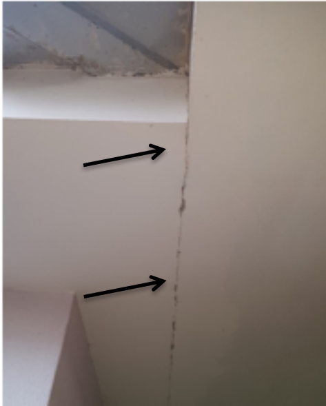
Trinca devido a união de lajes de concreto
