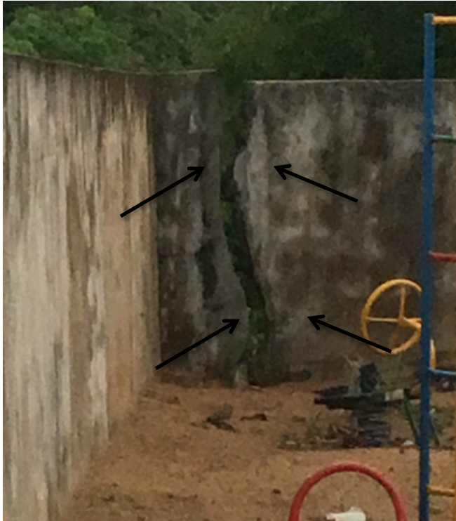
Figura 22: Fenda devido recalque da contenção
