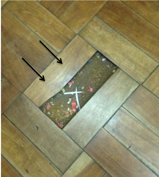
Figura 25: Descolamento do piso
