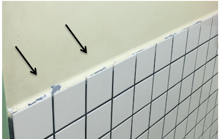
Descolamento da pintura área interna
