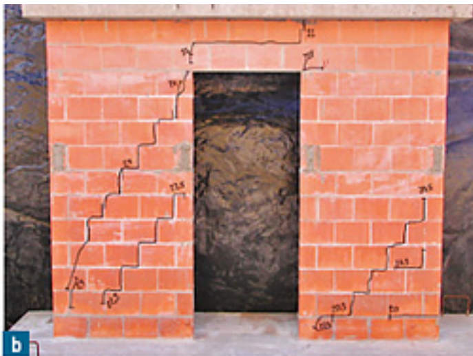
Figura 10: Fissura decorrente da não utilização de verga
