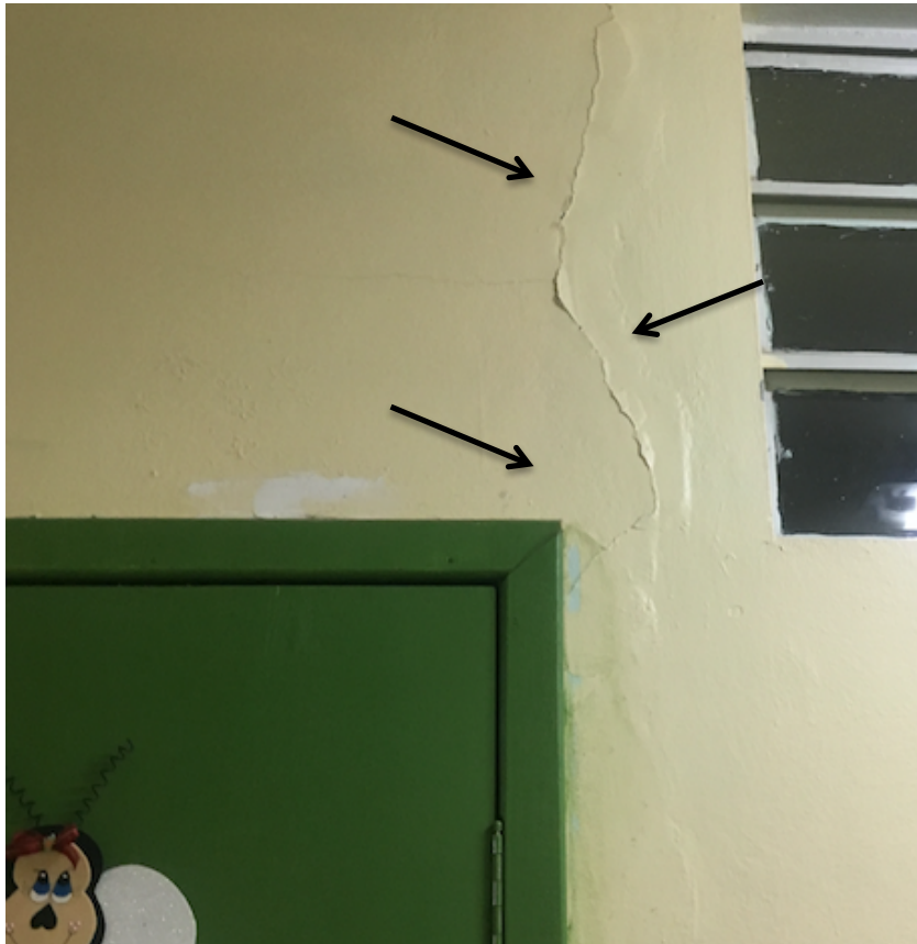
Figura 20: Fissura por sobre carga
