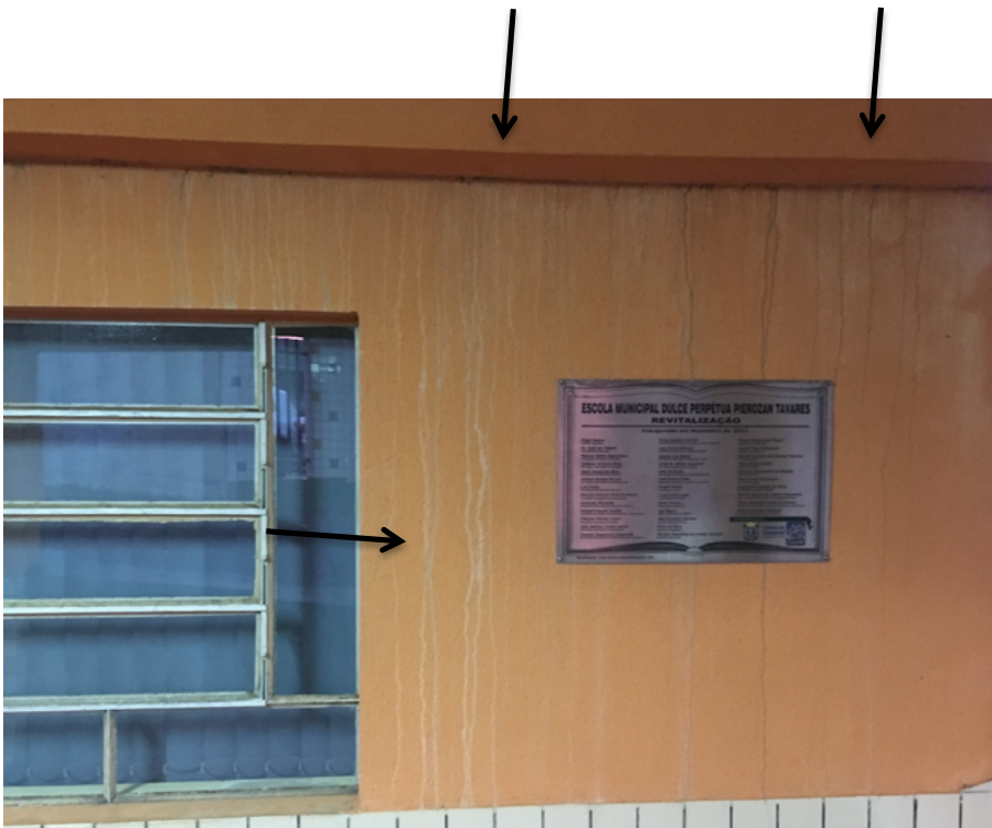
Eflorescência devido a umidade da chuva
