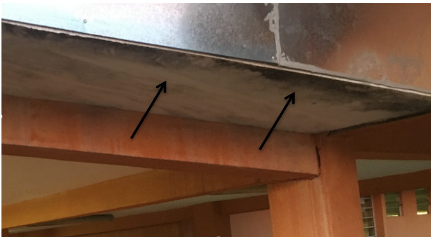
Infiltração e bolor na devida a umidade da chuva
