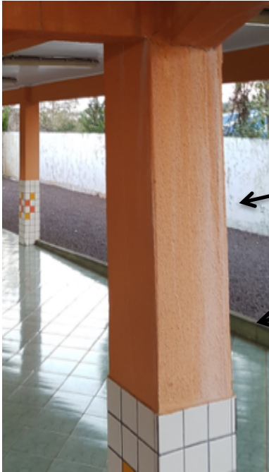
Eflorescência no pilar
