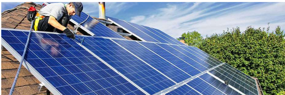
Figura 5: Painéis fotovoltaicos instalados no telhado
