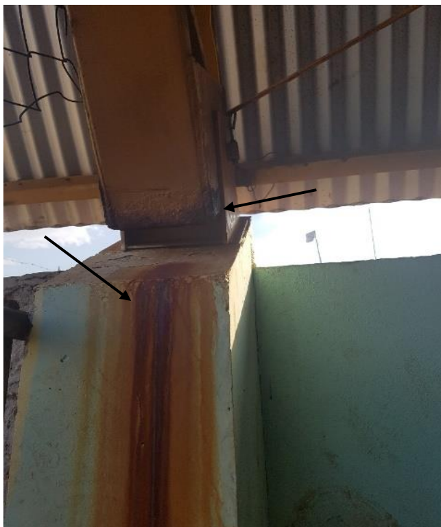
Figura 29: Oxidação na estrutura metálica do ginásio
