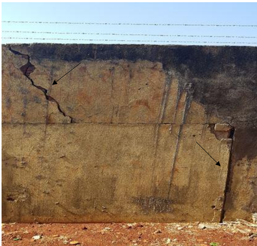
Figura 23: Rachadura no muro
