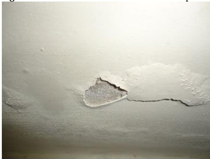
Figura 12: Descolamento do revestimento em placa
