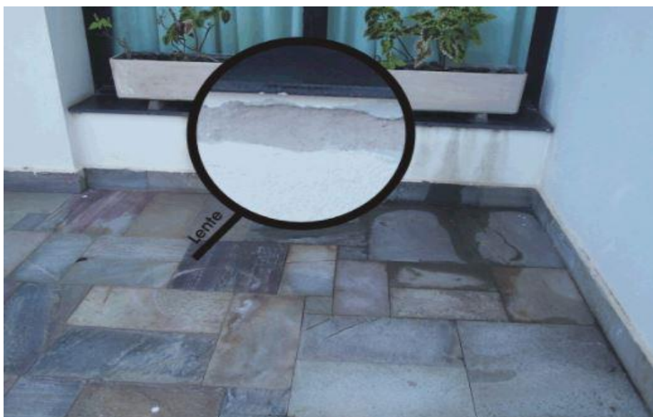
Figura 13: Descolamento por pulverulência no reboco/emboço
