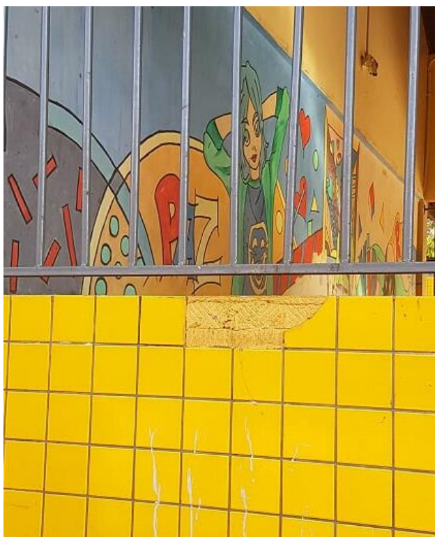
Figura 38: Descolamento em placa do revestimento cerâmico
