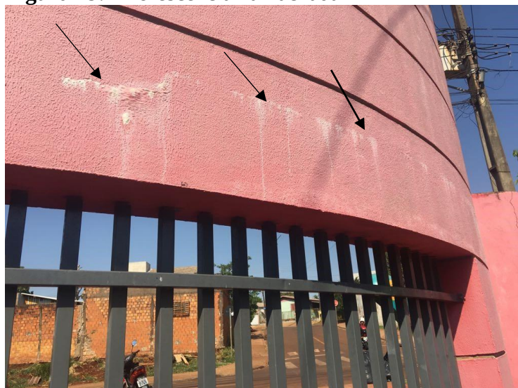
Figura 19: Eflorescência na Fachada
