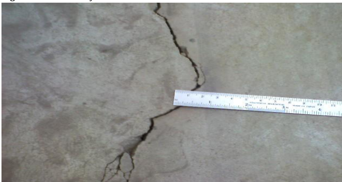
Figura 3: Trinca em laje.
