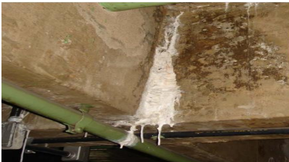
Figura 10: Eflorescência no encontro de vigas
