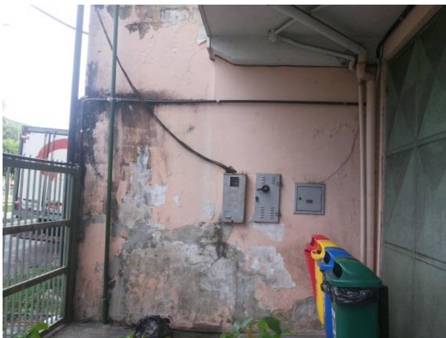
Figura 11: Muro com bolor
