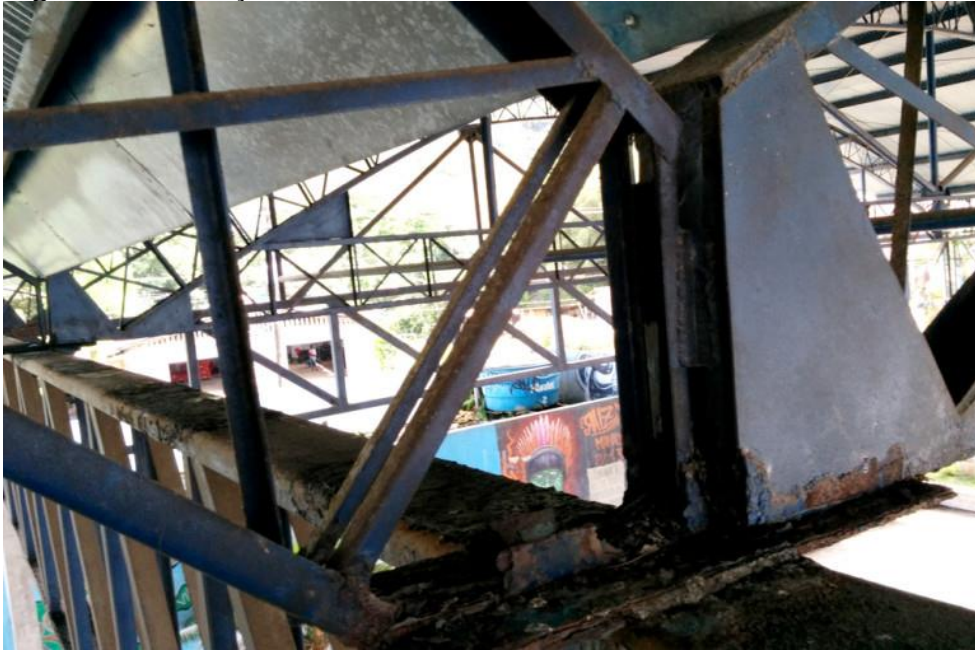
Figura 15: Oxidação em estrutura metálica
