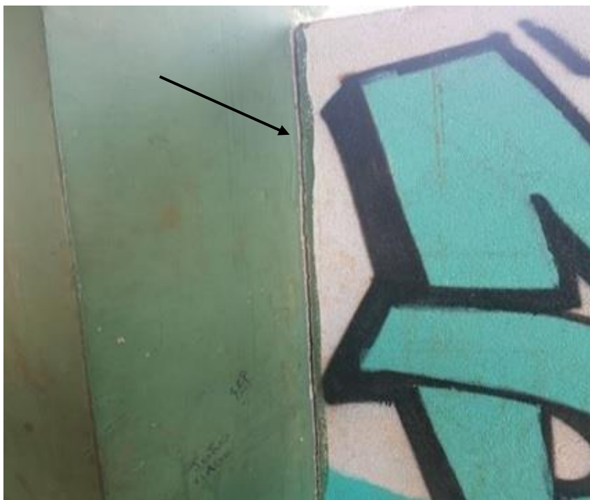
Figura 30: Fissura vertical no encontro entre pilar e alvenaria.
