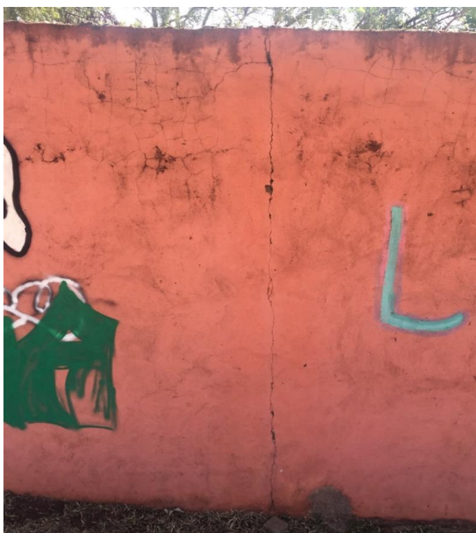
Figura 25: Fissura vertical por movimentação térmica
