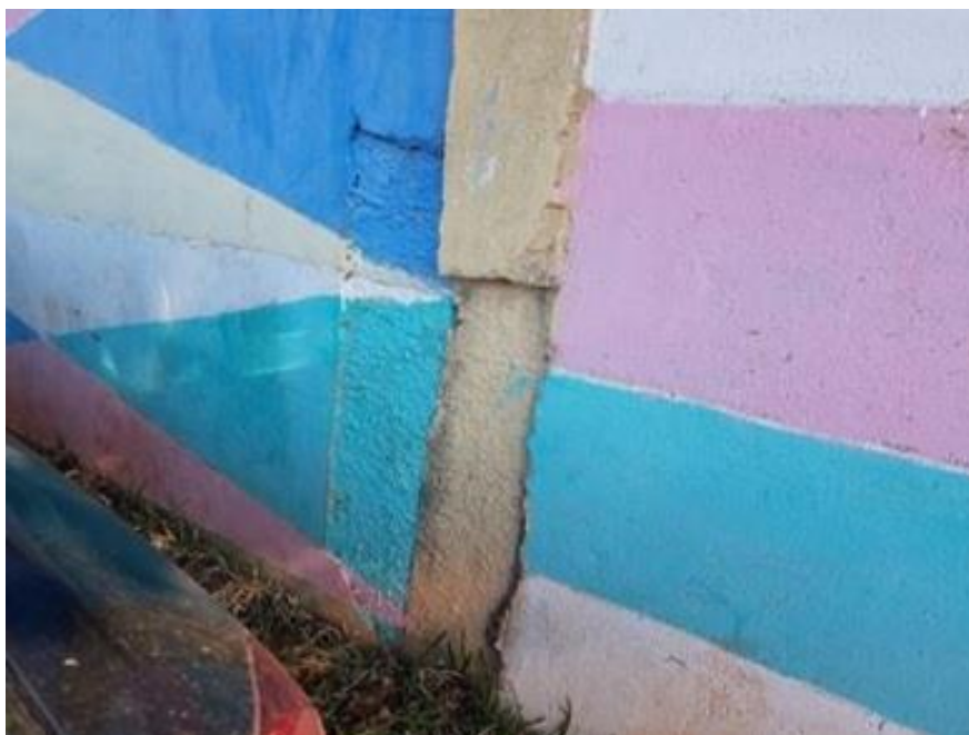
Figura 28: Descolamento do revestimento argamassado em placa
