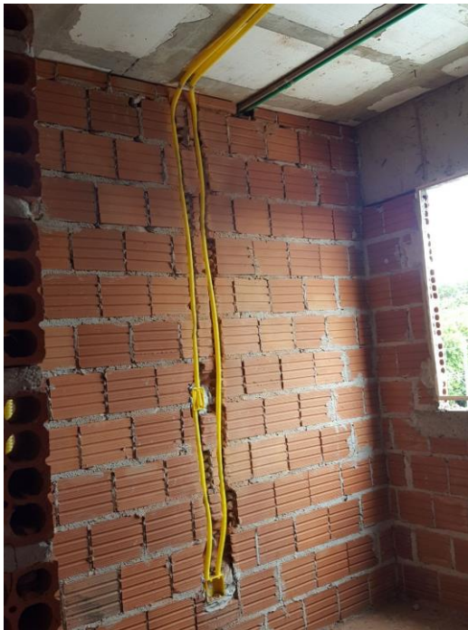
Figura 10 - Tubulação para passagem da fiação
