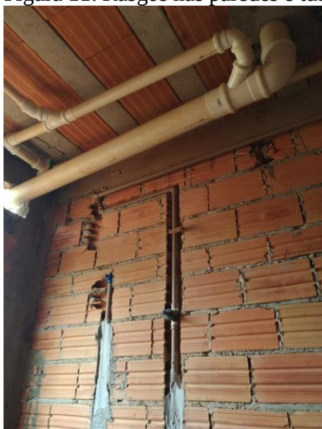
Figura 11: Rasgos nas paredes e tubos hidráulicos.
