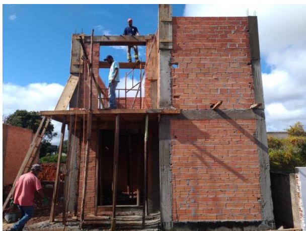
Figura 18: Falta de EPI's pelos pedreiros.
