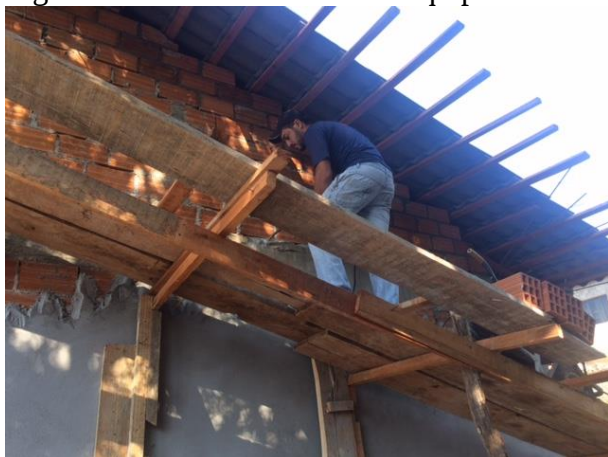
Figura 4 – Trabalhador sem os equipamentos de segurança necessários
