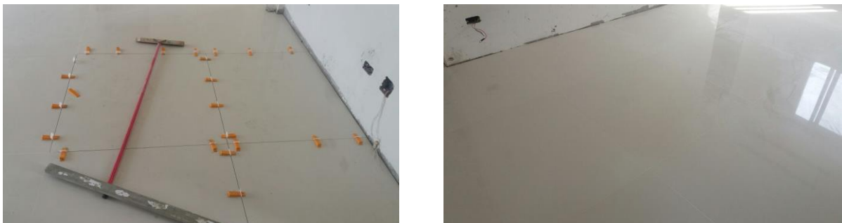
Figura 25 – Assentamento do piso no interior dos apartamentos
