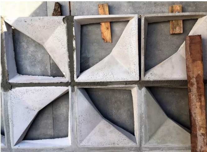
Figura 14 - Assentamento de revestimento
