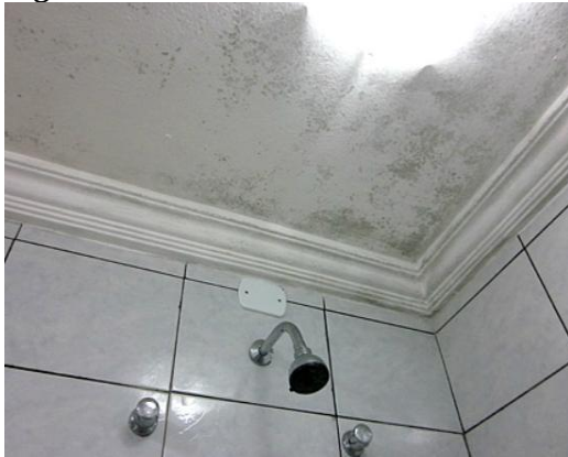
Figura 6: Causas de bolor em banheiro
