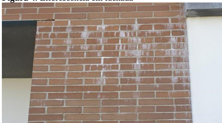
Figura 4: Eflorescência em fachada
