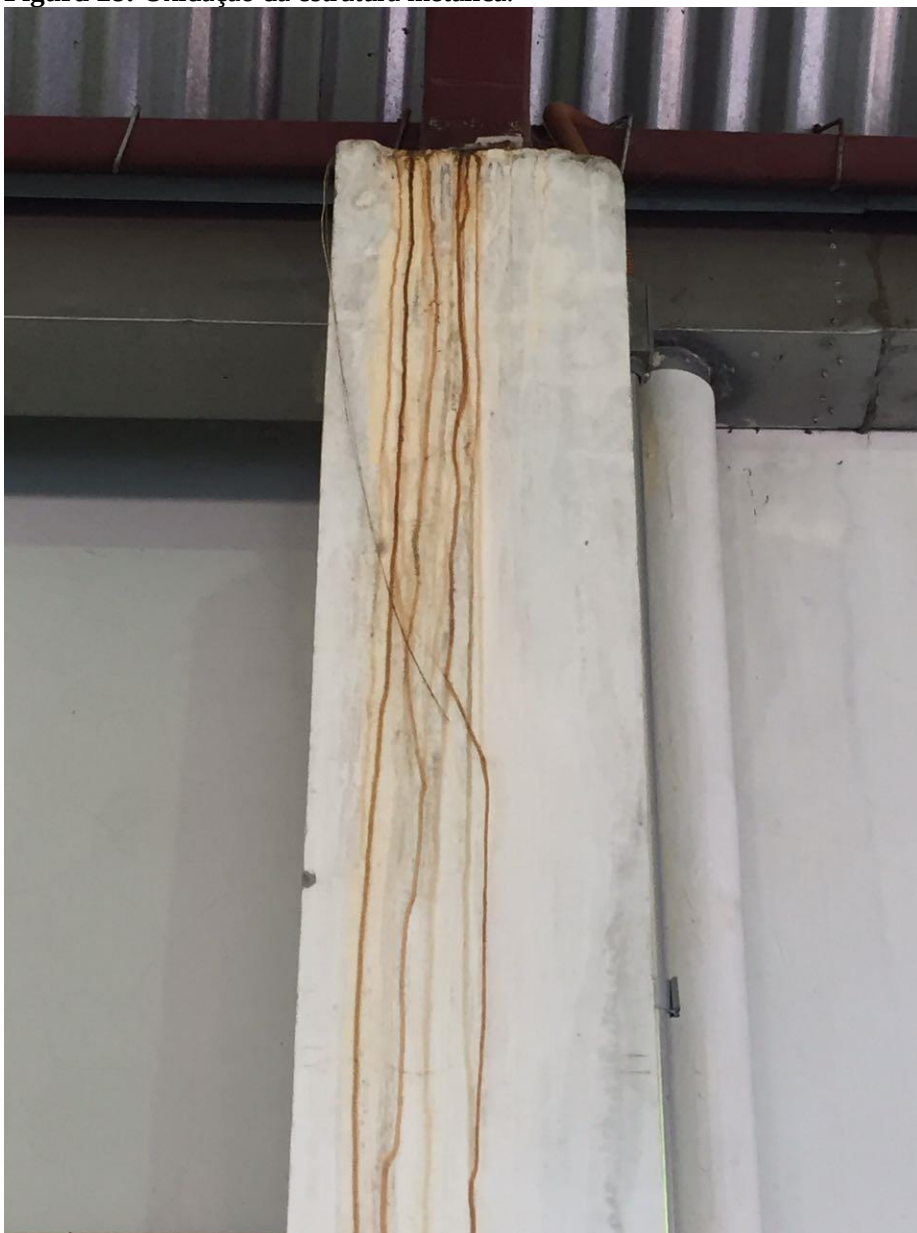
Figura 28: Oxidação da estrutura metálica.
