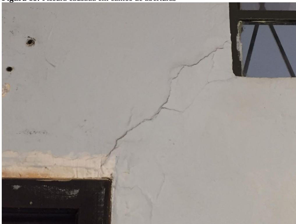
Figura 18: Fissura causada em cantos de aberturas
