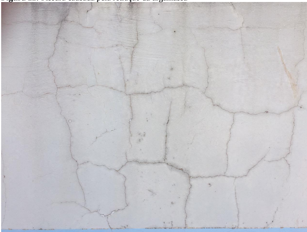
Figura 22: Fissura causada pela retração da argamassa
