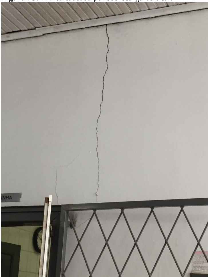
Figura 13: Trinca causada por sobrecarga vertical.
