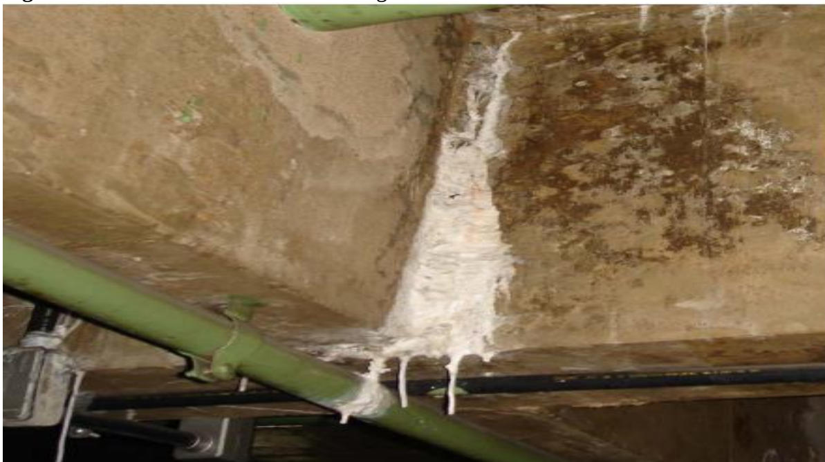
Figura 3: Eflorescência no encontro de vigas
