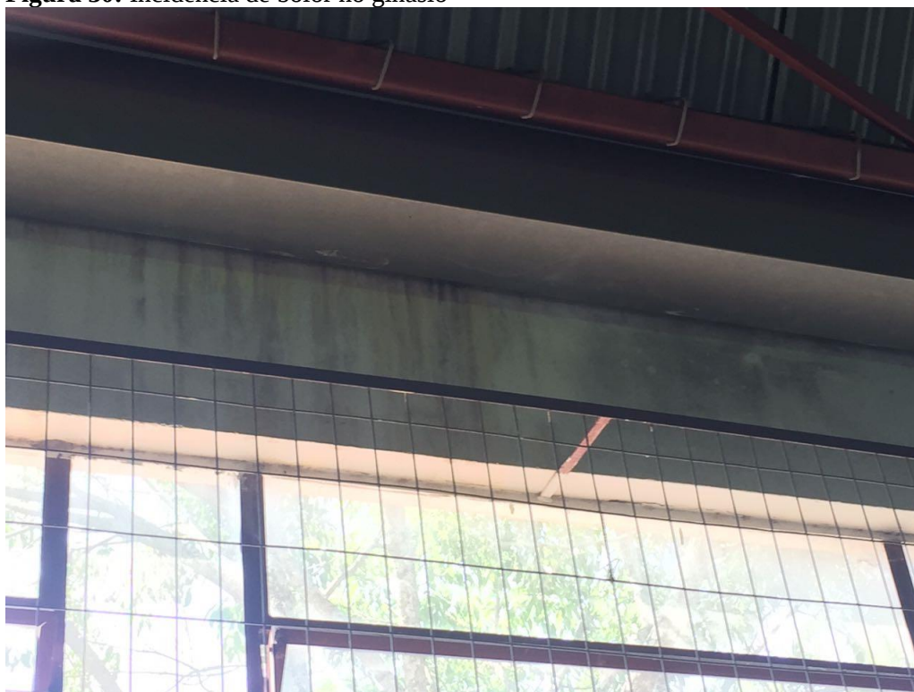
Figura 30: Incidência de bolor no ginásio
