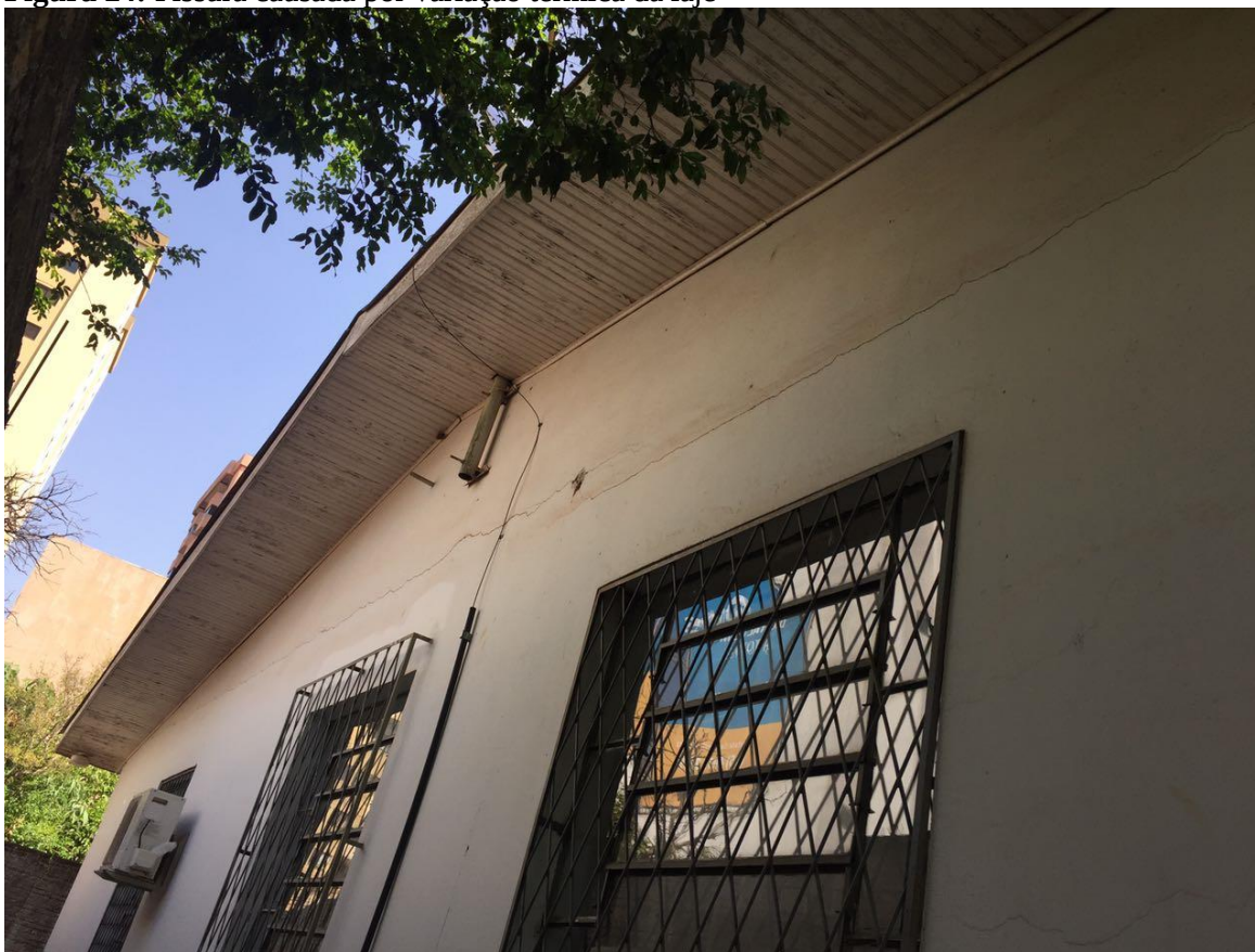
Figura 24: Fissura causada por variação térmica da laje
