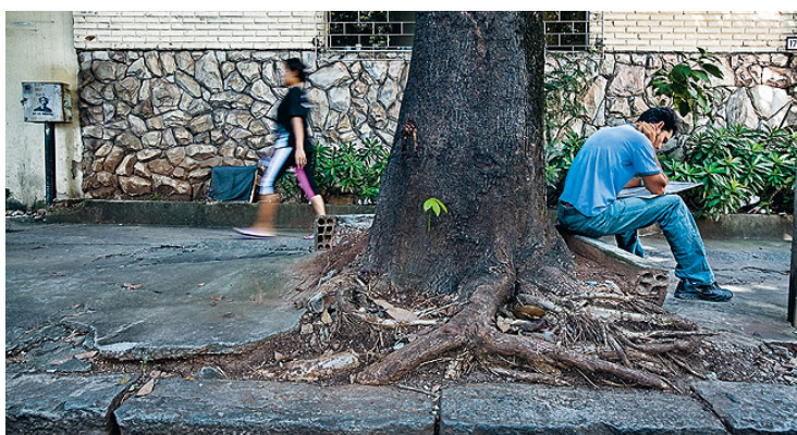
Figura 04: Árvore com raízes aflorando a calçada.
