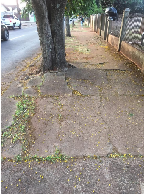
Figura 08: Raízes destruindo a calçada.
