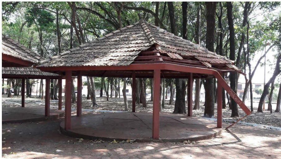
Figura 7 - Gazebo vandalizado e sem manutenção
