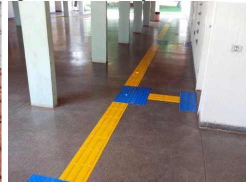
Figura 02. Piso tátil de pvc
