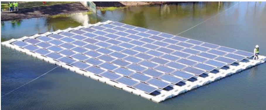
Figura 14. Sistema de geração solar flutuante
