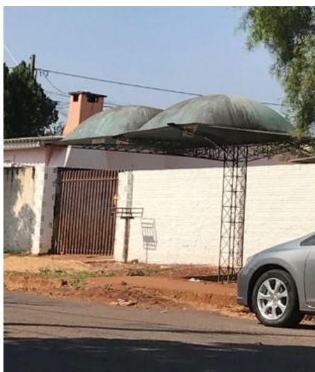
Figura 08 – Ponto de Ônibus Precário.
