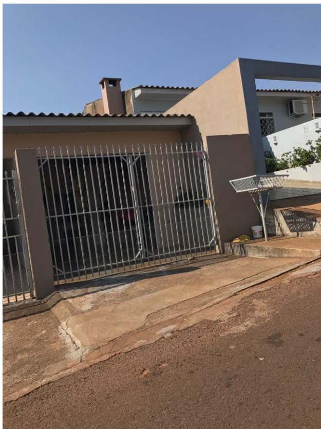
Figura 17 – Calçada com Desnível Resolvido com Muro e Talude.
