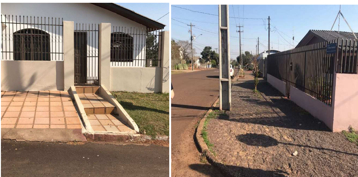
Figura 6 e 7 - Passeio público com a calçada irregular.
